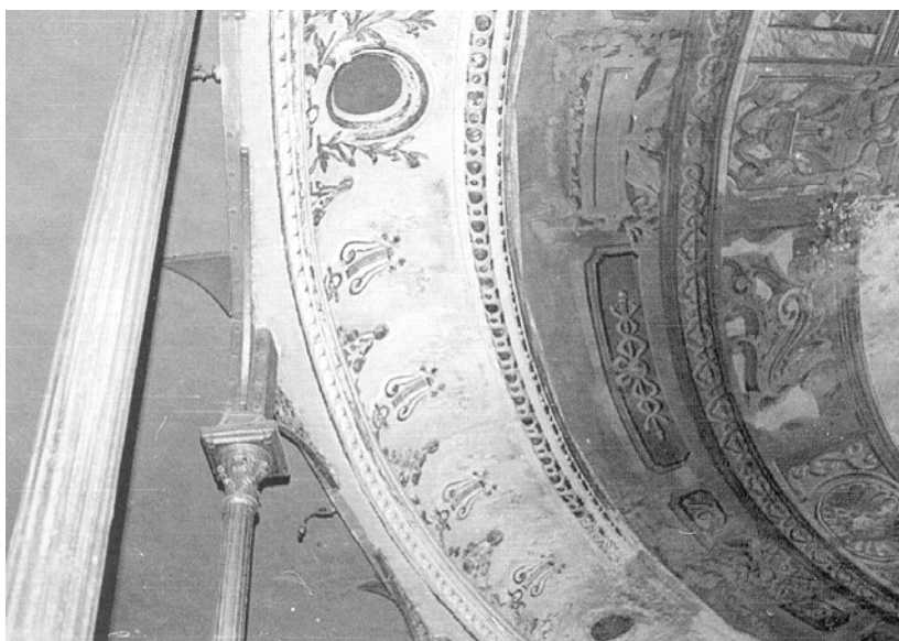
Lám. 31. Columnas de hierro que soportaban el mural pictórico del techo. Teatro Espinel. Ronda.
