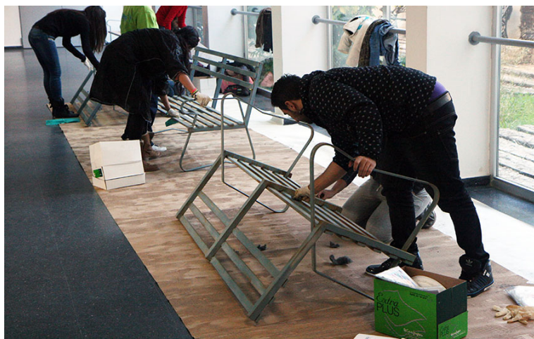
FIGURA 2. Bancos metálicos sobre los que se realizaron las intervenciones de la primera acción de co-creación. Facultad de Formación del Profesorado (Cáceres).
