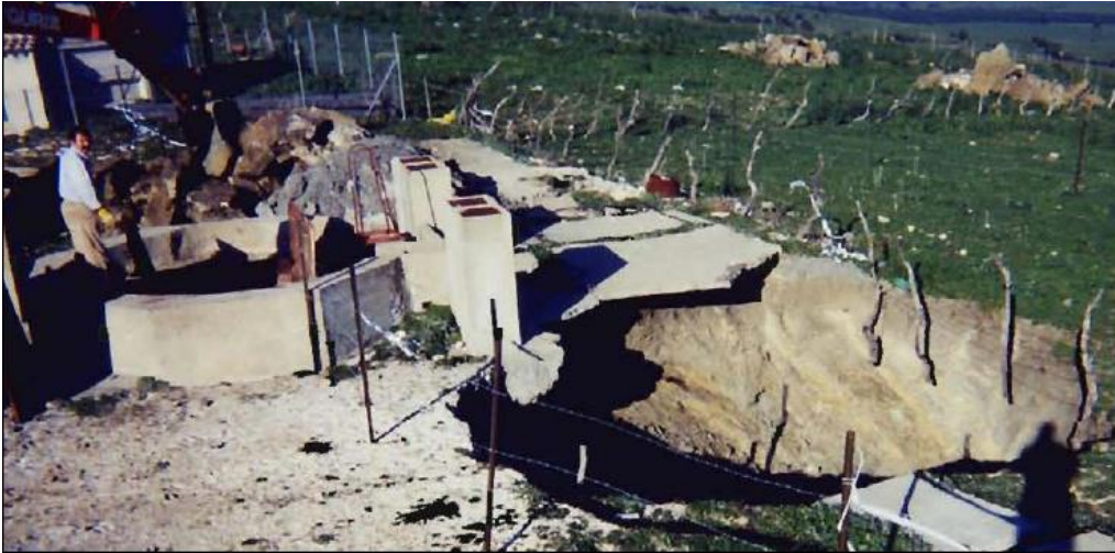
Figura 7: Socavón junto al brocal del pozo de Bolonia el 24 de enero de 2000 (Esteras 2000).
