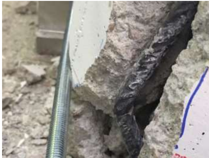
Figura 26: Rottura dell' armatura longitudinale destra di spigolo .
