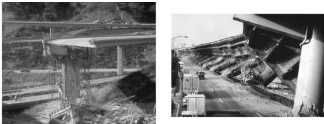
Figura 160: - Terremoto di San Fernando 1971 (a sinistra); terremoto di Kobe, Giappone 1995: collasso del viadotto urbano Hanshin (a destra) [72]
