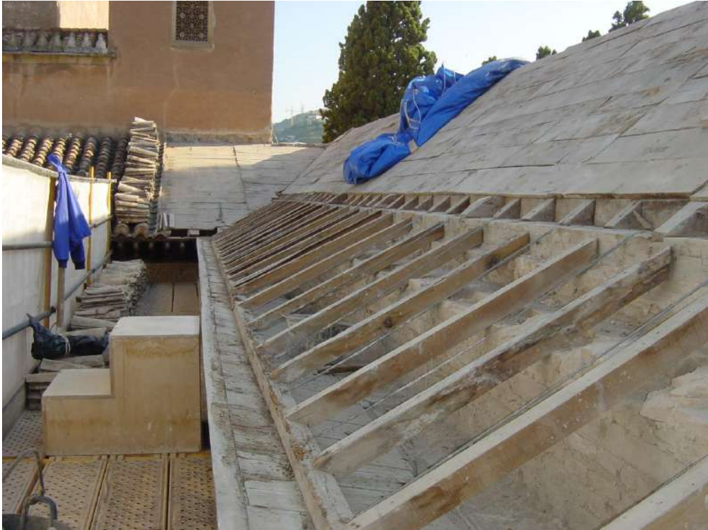
Fig. 136. Imagen donde se observa en un alero las actuaciones de refuerzo realizadas por Prieto Moreno. Alero de la nave de levante del Patio de Arrayanes. (Fotografía de M a Victoria Mir de Miguel, 2003).
