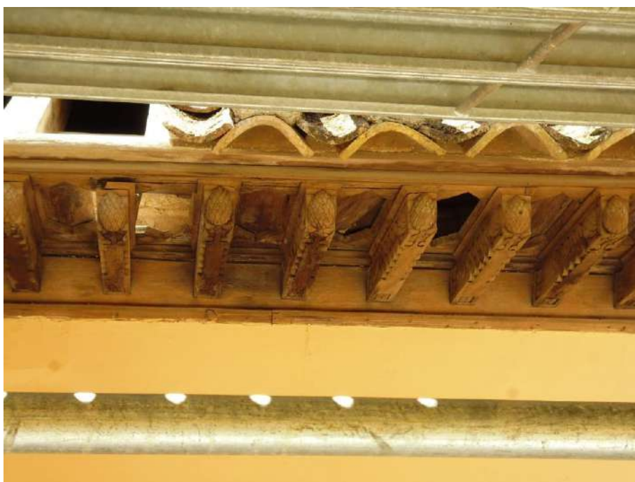
Fig. 303. Alero del cuerpo aledaño a poniente de la sala de Abencerrajes. (Fotografía de la autora, 2017).
