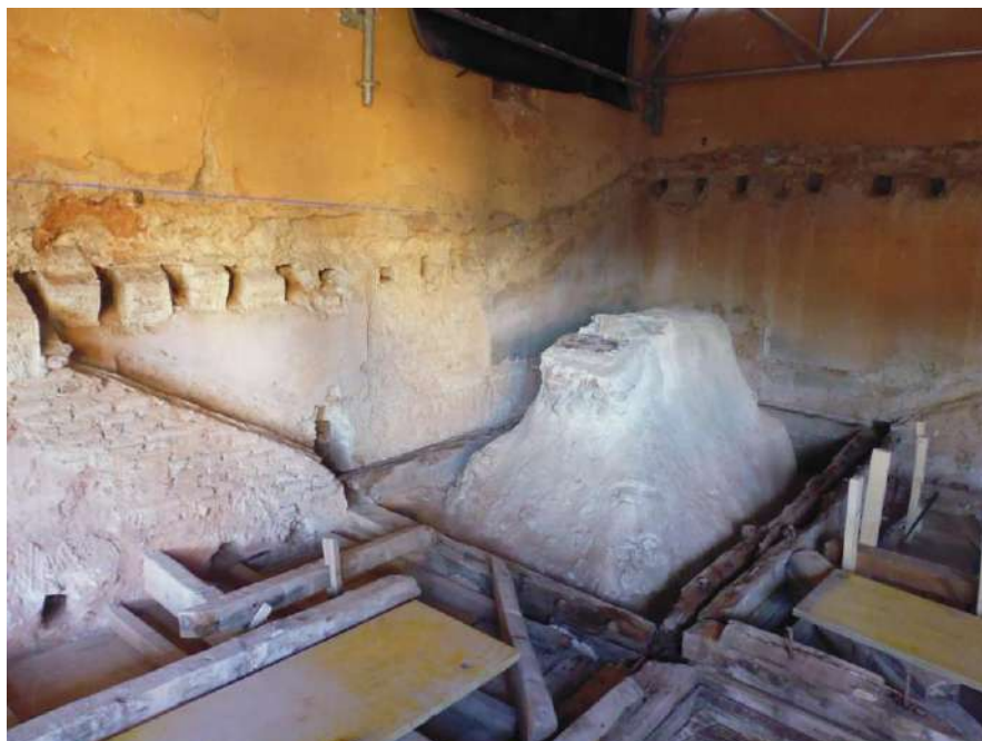
Fig. 270. Bóveda de mocárabes bajo la esquina suroeste de las cubiertas de la galería del Patio de los Leones. Se observa que la estructura se encuentra rodeada de un sistema de estribos para recoger la armadura y las canales correspondientes al pabellón construido. (Fotografía de la autora, 2016-17).
