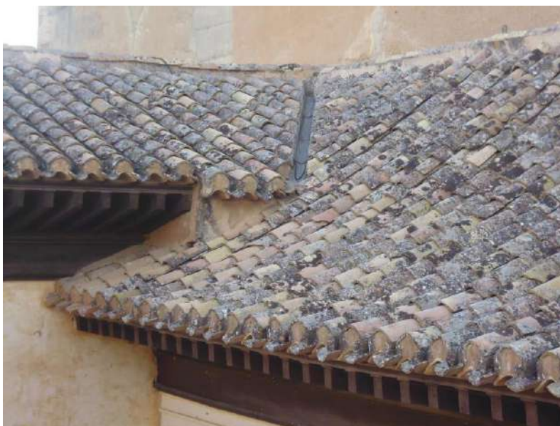
Fig. 132. Remate de las bocatejas con el sistema “a la toledana”. Cubiertas cuyas aguas dan al Patio del Cuarto Dorado. (Fotografía de la autora, 2017).
