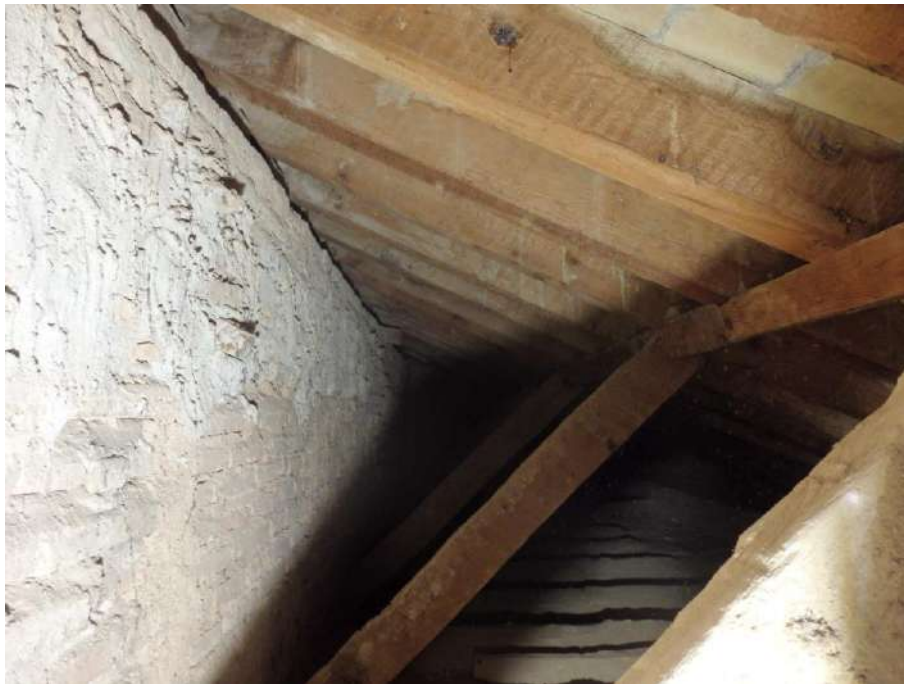
Fig. 124. Armadura de pares reforzada con jabalcones que sustenta la cubierta del pasillo oriental de la Sala de Abencerrajes. (Fotografía de la autora, 2017).
