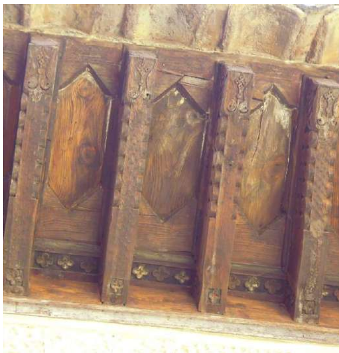
Fig. 23. Alero del Harem en el faldón sur. En este vuelo se conservan aún las tablillas originales de remate de las cobijas junto al muro. (Fotografía de la autora, 2017).
