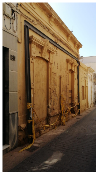
Anexo 32. Estado actual de la calle Silencio 54. Imagen propia.
