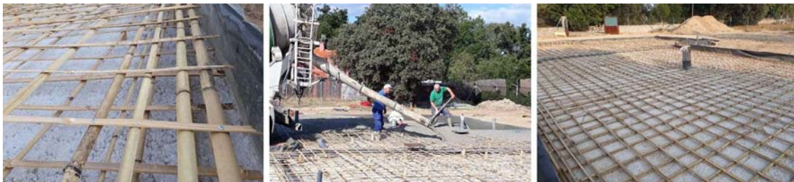
Figura 63. Armado de bambú de la solera de hormigón bastardo de cal y cemento de una vivienda ecológica situada en las afueras de Madrid (España) realizada por la empresa de bioconstrucción Econhouse. Fuente: Bambusa Estudio.
