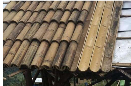
Figura 65. Cubierta inclinada tradicional con cobertura de medias cañas de bambú Guadua. Fuente: Bamboo Grassroots Atelier.
