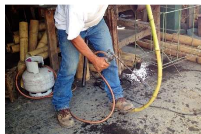
Figura 44. Proceso de doblado de un culmo de bambú mediante soplete. Fuente: Guadua Bamboo.
