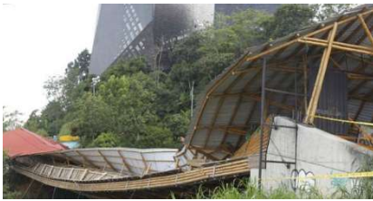
Figura 82. Puente de Santo Domingo Savio (Medellín, Colombia) colapsado. Fuente: Semana S.A.
