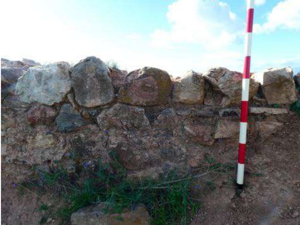
Figura 269: Enlucido en la cara interna del lienzo 3. Fuente: elaboración propia.
