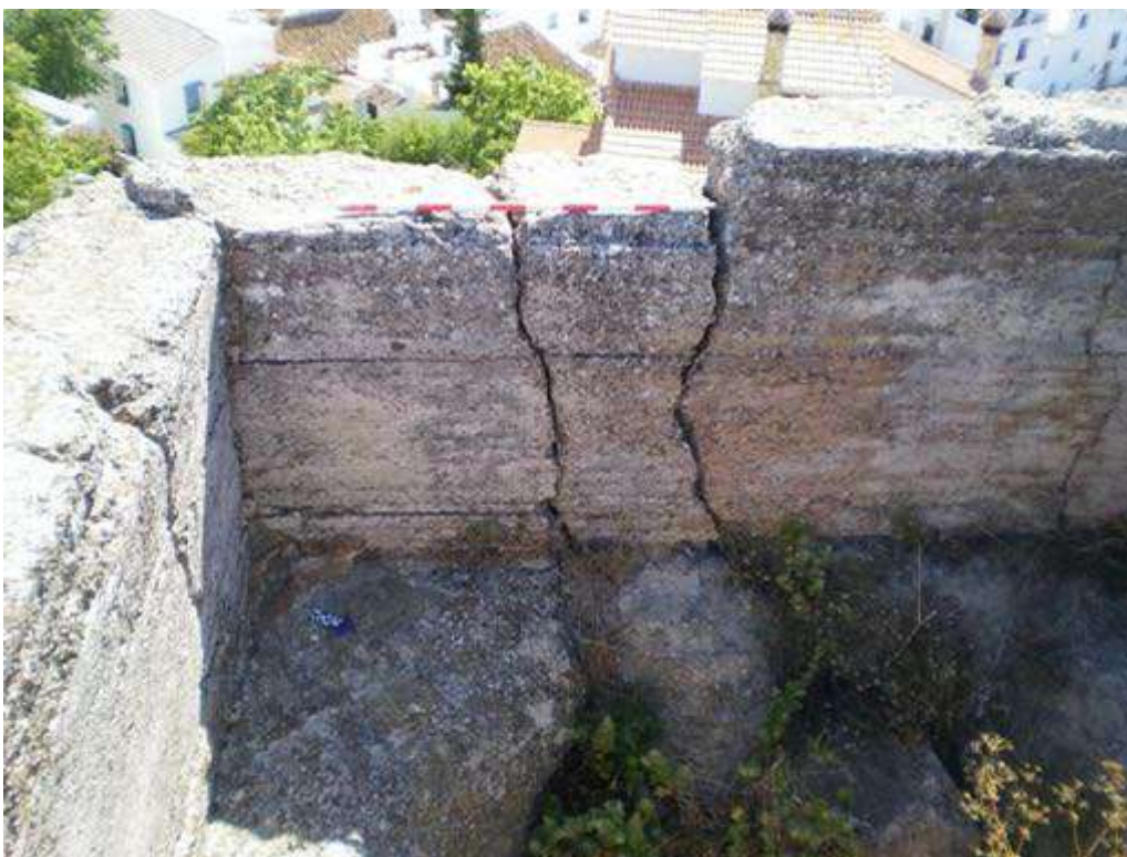
Figura 452: Restos de la solería de ladrillo en la esquina suroccidental. Vista de la cara oeste. Fuente: elaboración propia.
