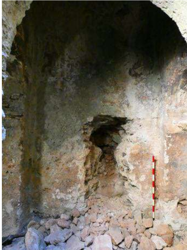
Figura 148: Vista del lateral oriental del compartimento VI donde se aprecia una rotura en el muro que demuestra los materiales y técnica constructiva. Fuente: elaboración propia.
