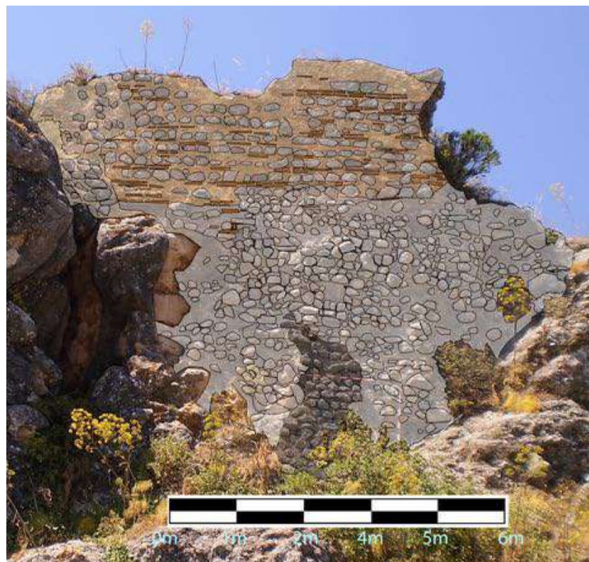
Figura 472: Lienzo 3 y sus distintas fases constructivas. En gris, la primera fase en la parte inferior, con mampostería ordinaria. En marrón claro, la segunda en la parte superior, mampostería regular con verdugadas de ladrillo. Fuente: elaboración propia.
