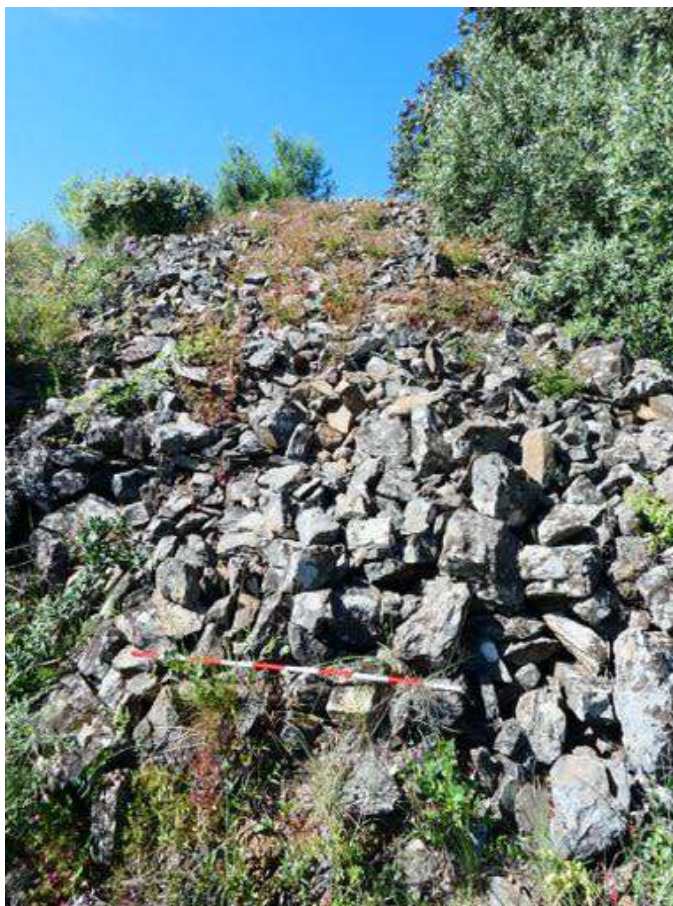
Figura 47: Gran derrumbe en la parte oriental del cerro. Fuente: elaboración propia.
