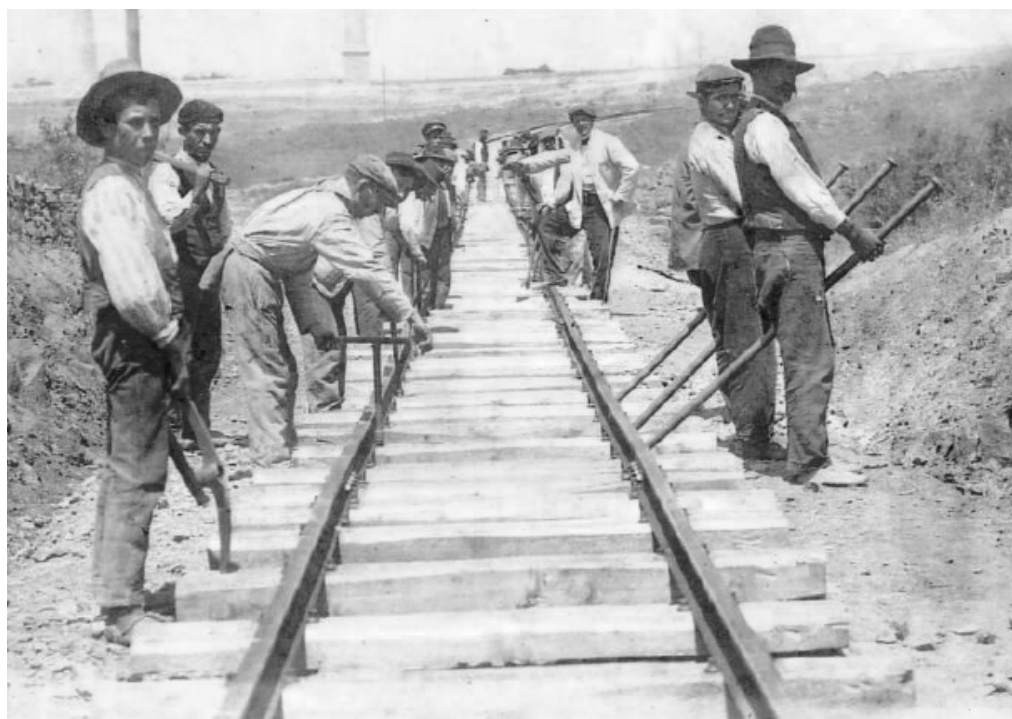
Trabajadores instalando vía férrea Linares-La Carolina, 1909 La minería y la metalurgia en el Alto Guadalquivir
