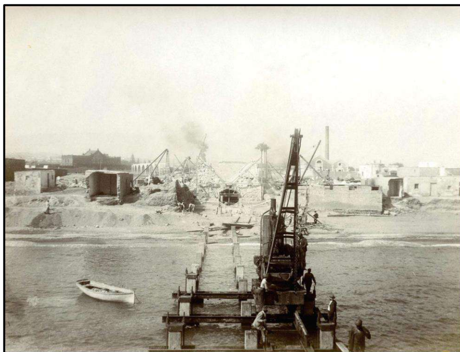
Ilustración 138. Construcción del Cable Francés hacia 1915. Fuente: Biblioteca Digital de la Diputación de Almería. Recuperado el 11 de noviembre de 2020, de https://app.dipalme.org/pandora/?view=global
