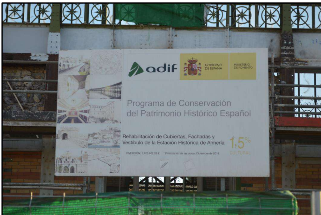
Ilustración 94. Cartel informativo de las obras de rehabilitación que se están llevando a cabo actualmente en la Estación. Obsérvese la fecha de finalización: diciembre de 2018. Autoría propia.
