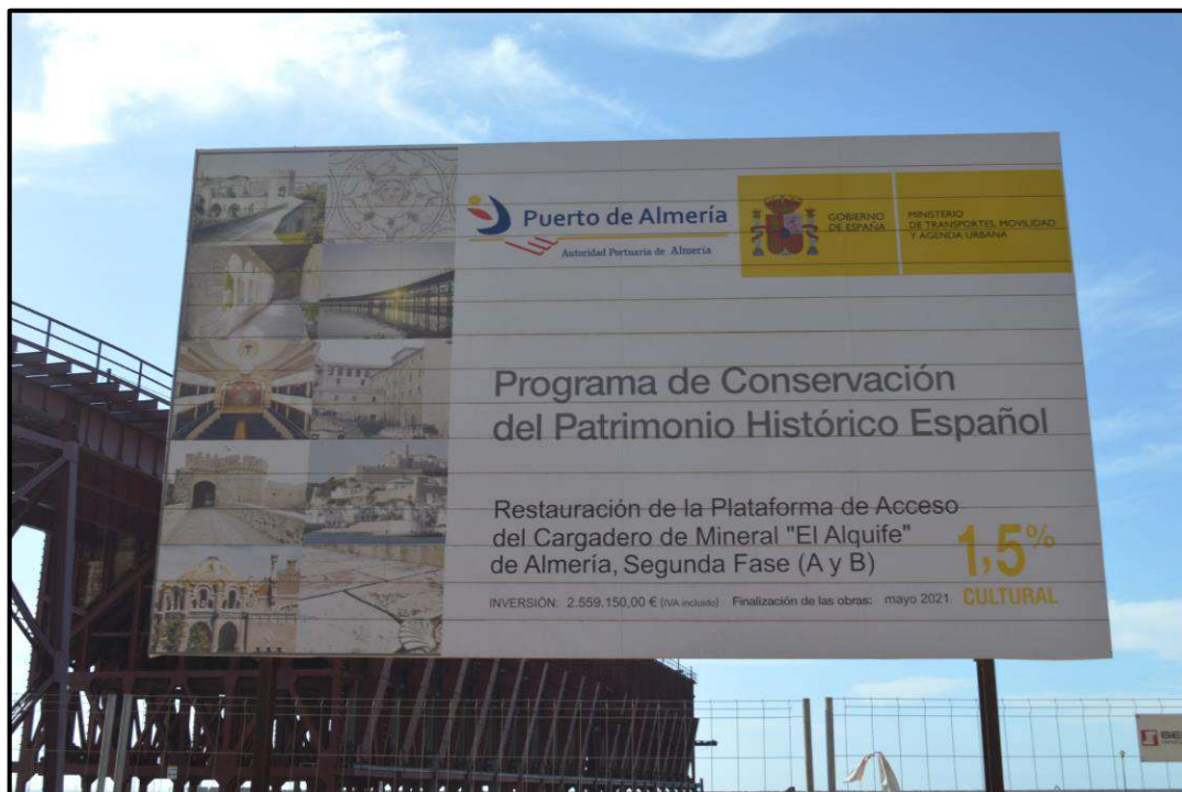
Ilustración 116. Cartel informativo de las actuaciones de conservación (Segunda Fase) que se están llevando a cabo en el Cable Inglés. La fecha estimada de finalización es en mayo de 2021. Autoría propia.
