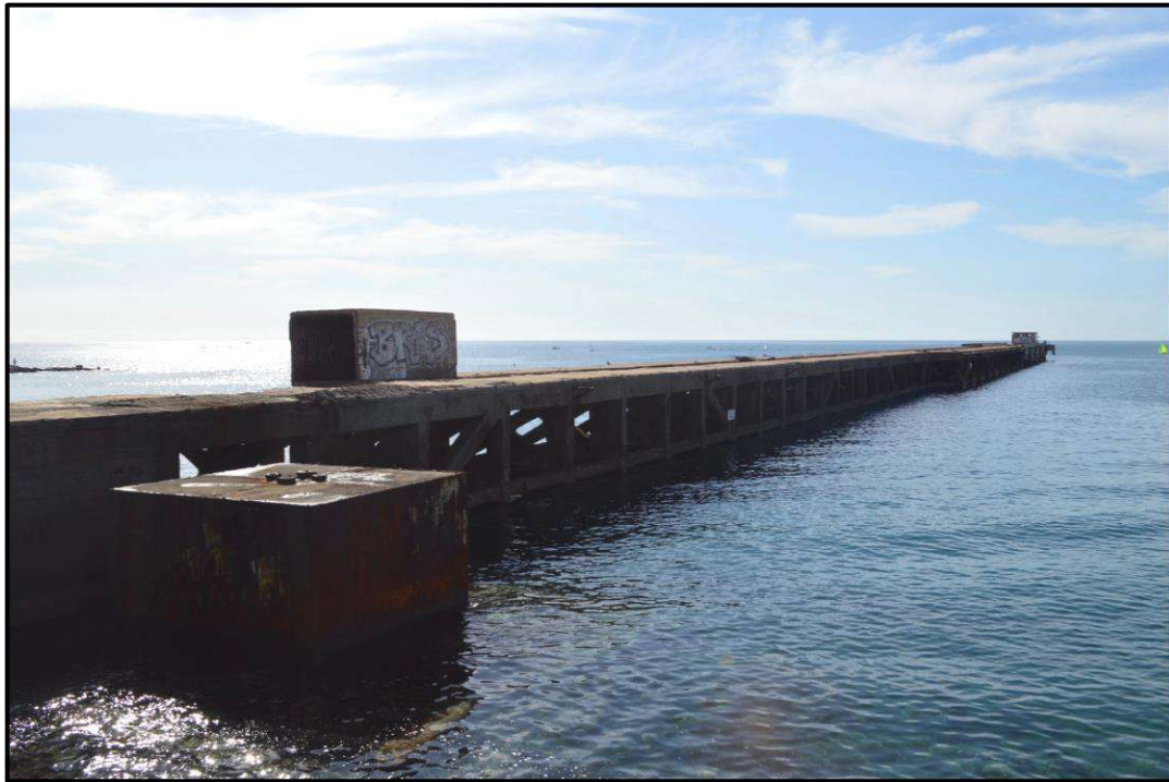
Ilustración 148. Estado actual del Cable Francés totalmente desmantelado. Autoría propia.
