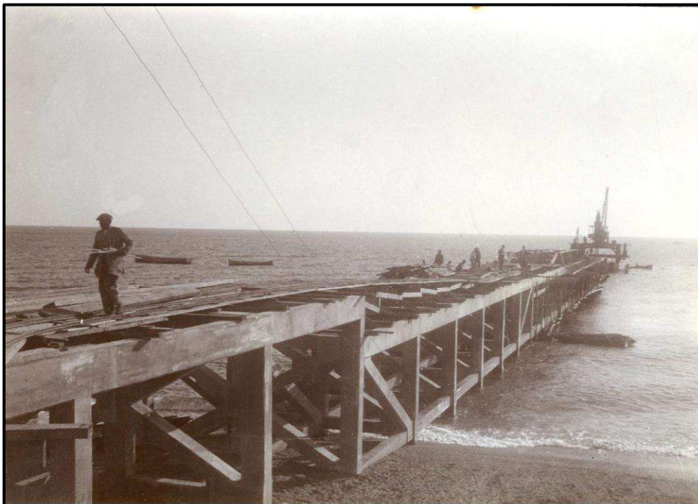
Ilustración 140. Construcción del Cable Francés hacia 1916. Fuente: Biblioteca Digital de la Diputación de Almería. Recuperado el 11 de noviembre de 2020, de https://app.dipalme.org/pandora/?view=global
