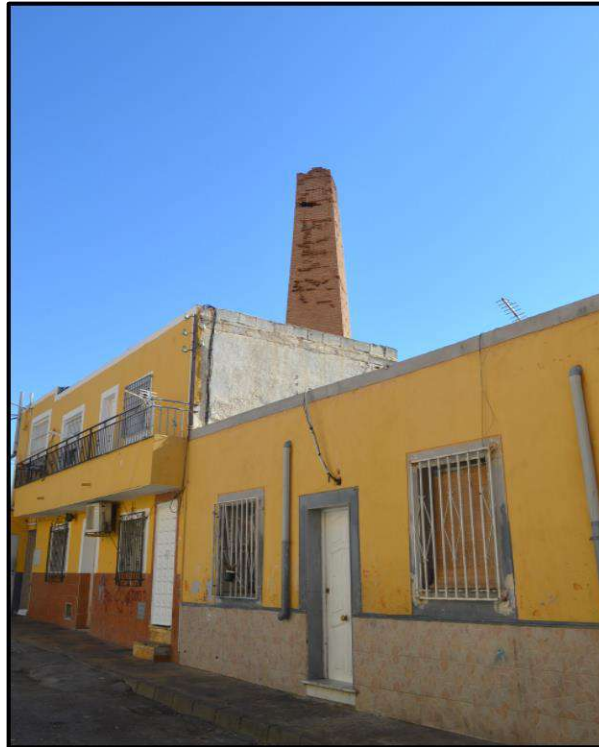
Ilustración 129. Estado actual de la chimenea principal de la Fundición Santo Tomás. Se aprecia su situación dentro de una vivienda. Autoría propia.
