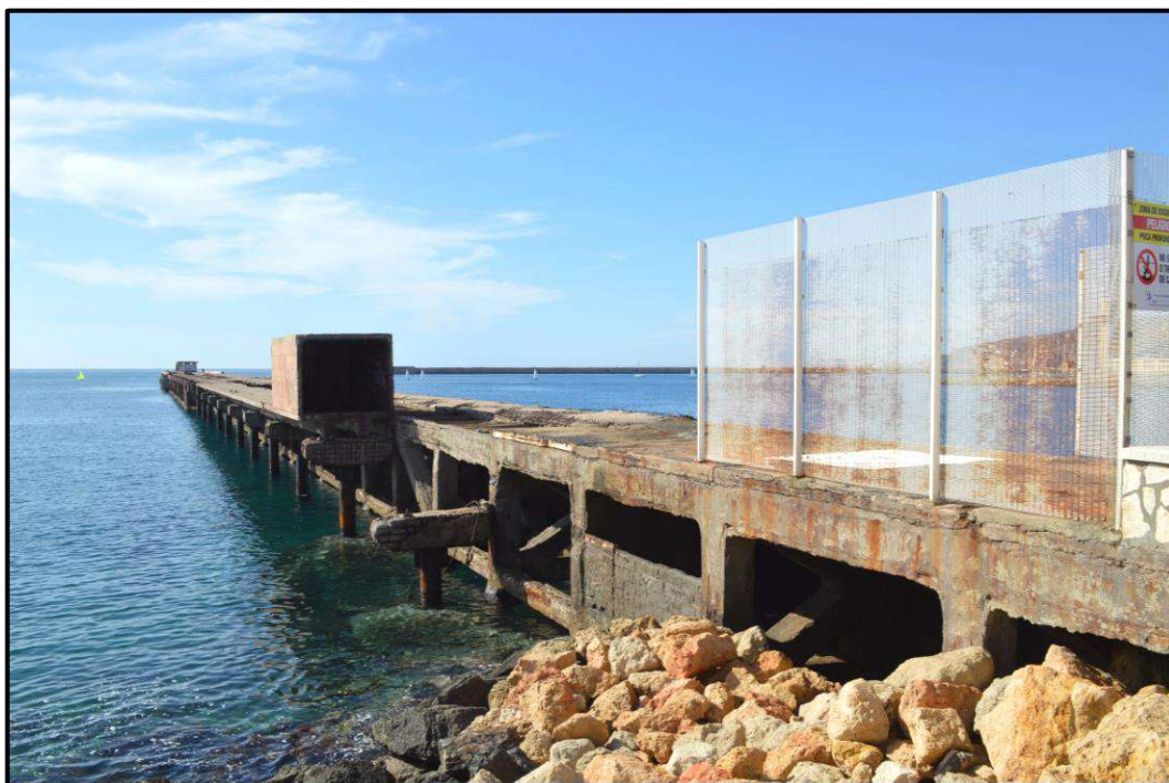
Ilustración 149. Cable Francés, con la valla que prohíbe el paso advirtiéndolo del peligro que supone. Autoría propia.
