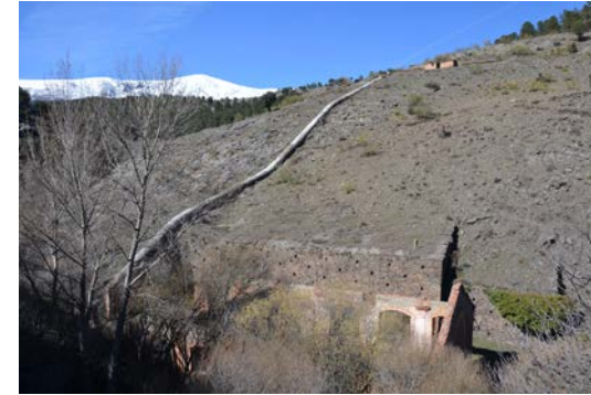
ILUSTRACIÓN 10. CASA DE MÁQUINAS, TUBERÍA FORZADA Y CÁMARA DE CARGA FOTOGRAFÍA DEL AUTOR
