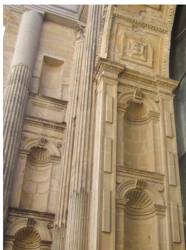
Ilustración 5. Francisco Prieto-Moreno. Restauración de la jamba derecha del arco toral. A la izquierda se puede ver la hornacina y pilastra restituidas por Nadal y Araujo. Elaboración propia.
