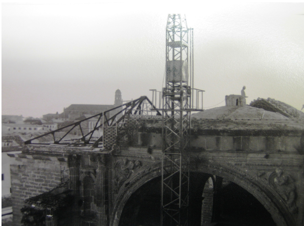
Ilustración 4. Obras de las cubiertas de San Francisco. Colocación de cerchas metálicas sobre el crucero. Autor: José Antonio Llopis. Con permiso para su publicación en erph.
