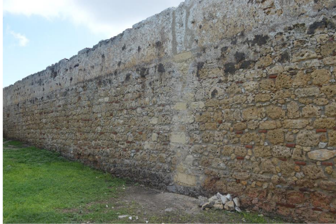
Figura 149. Costura de seis grietas en la cortina entre los baluartes de San José y El Reducto en Getsemaní
