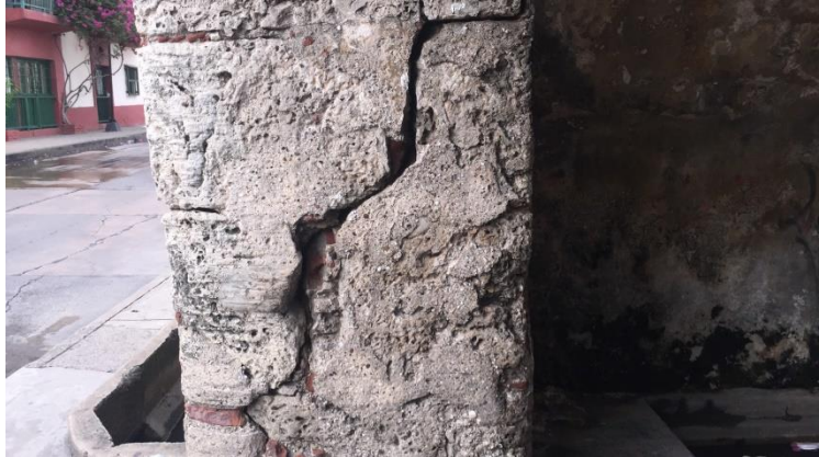
Figura 57. Grietas producidas por el tránsito vehicular
