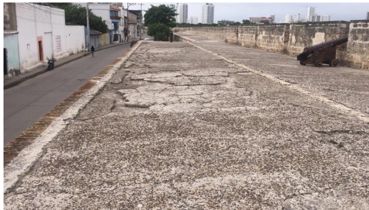
Figura 54. Grietas presentadas por socavación
