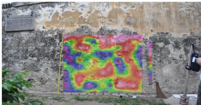
Figura 167. Humedad de la superficie en la zona de estudio edificio militar de las Bóvedas
