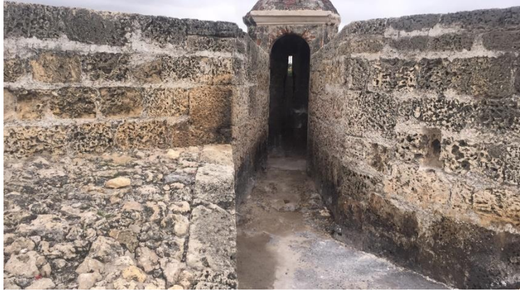
Figura 59. Lugares afectados por el uso inadecuado (baños)
