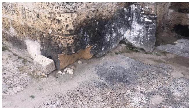
Figura 64. Deterioro causado por orina
