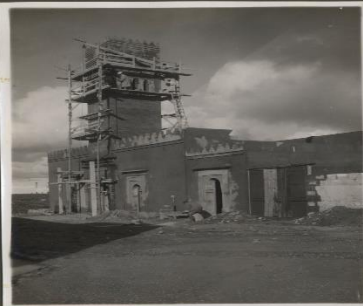
MEZQUITA KADIRIA. La Zawiya en construcción. En primer término, puerta de acceso al pabellón de abluciones, retretes, etc.
