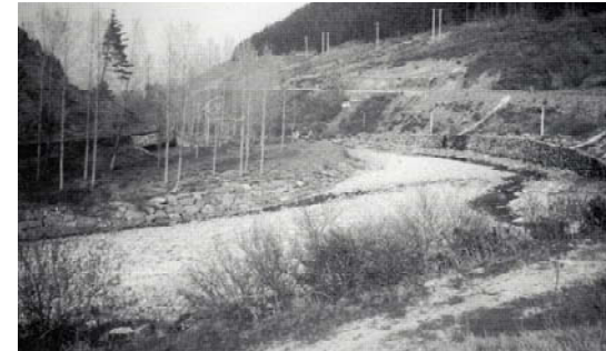
Protección con escollera. Fuente: UC, 1999
