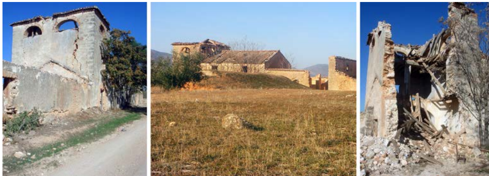
Imágenes del antiguo torreón (año 2.007) y estado actual torreón derribado de la Dehesilla.
