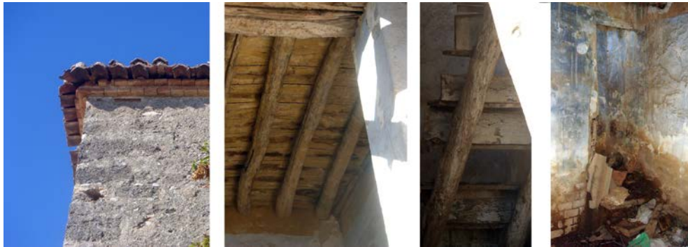
Revestimientos exteriores, estructura de madera, escaleras y acabados interiores de la Dehesilla
