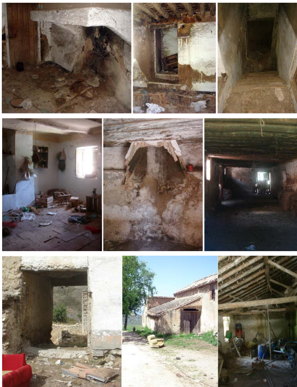
Imágenes interiores de la vivienda 2 y anexo zona baja del Cortijo de los Asperones.
