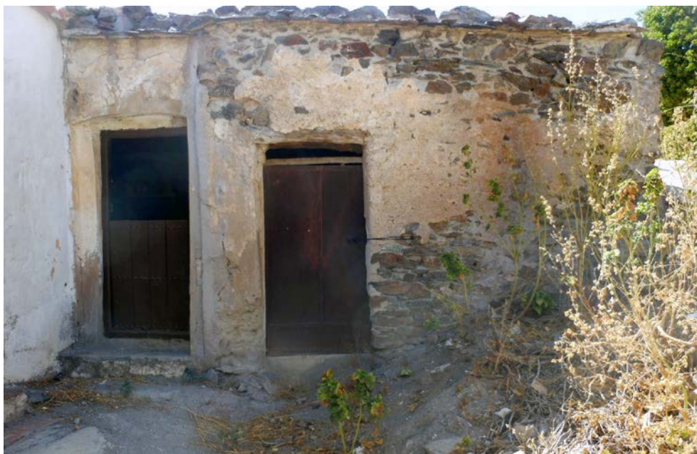
Acceso a dependencias de bodega y prensa, y vivienda 2 del cortijo de los Rafeles.
