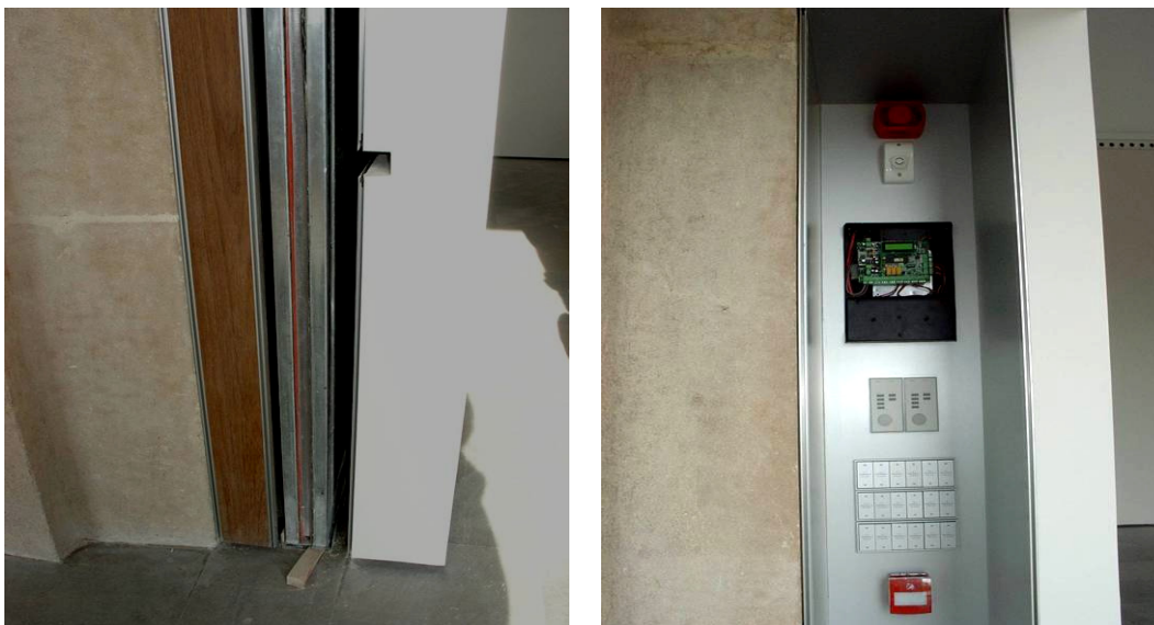
Figura 3.37. Museo de Bellas Artes de Granada. Izquierda: perfil metálico de una puerta cortafuegos situada entre dos salas expositivas. Derecha: panel de sistema de alarma situado en la jamba de una puerta entre dos salas.
