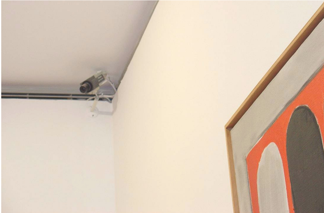
Figura 3.52. Sala de exposiciones de Centro José Guerrero (Granada). En la imagen se observa una cámara de seguridad colocada en una esquina formada por los muros y el techo de la estancia.
