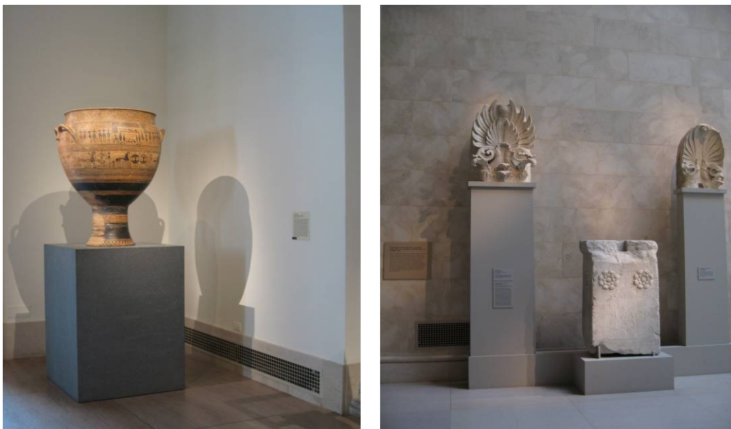
Figura 3.24. Sala de exposiciones del Metropolitan Museum (Nueva York), donde se pueden ver las rejillas que aparecen en las partes bajas de los muros utilizados en el sistemas de acondicionamiento ambiental.
