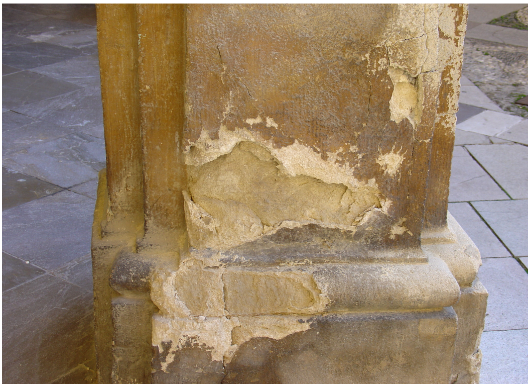
Figura 3.28. Deterioro acelerado en ambientes contaminados: arenización de piedra. Pilar perteneciente al pórtico del patio interior del Hospital de San Juan de Dios (Granada).
