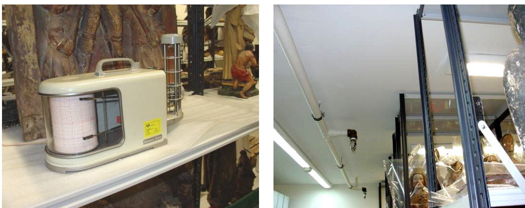
Figura 3.70. Almacén del MNAC (Barcelona). Izquierda: termohigrógrafo colocado entre las obras de arte para el control de humedad relativa y temperatura. Derecha: imagen de los sistemas de iluminación y anti-incendios instalados en el techo, cercanos a las estanterías que contienen las obras.
