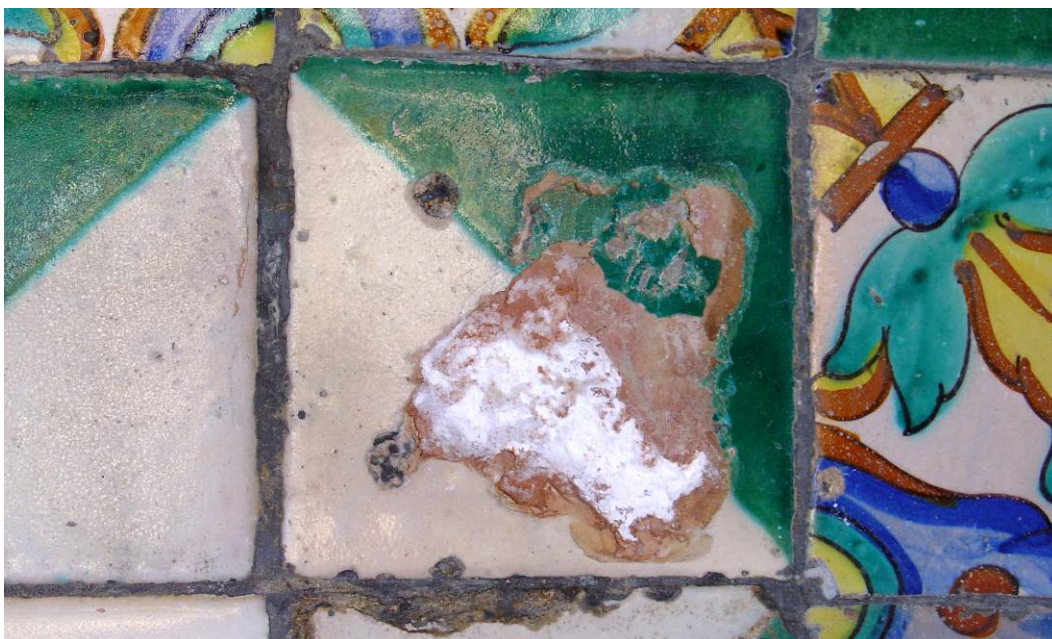
Figura 3.27. Material cerámico afectado por sales que se presentan como eflorescencias y han dado lugar al desprendimiento de la capa de esmalte.
