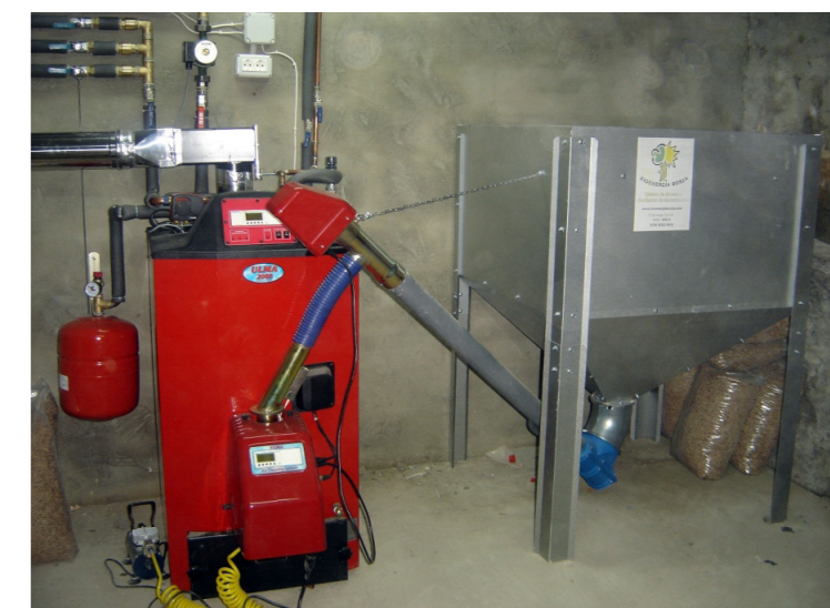
Caldera de Biomasa de pellets
