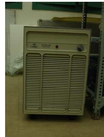
Deshumidificador del almacén donde se almacenan las piezas restauradas
