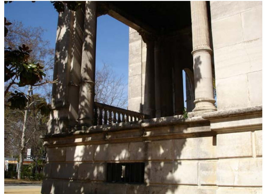
Ausencia de la balaustrada en terraza oeste
