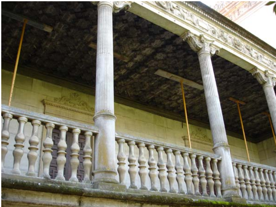
Terraza apuntalada por peligro de desprendimientos en el artesonado
