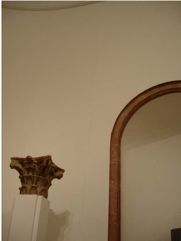
Grieta del óvalo desde la sala
