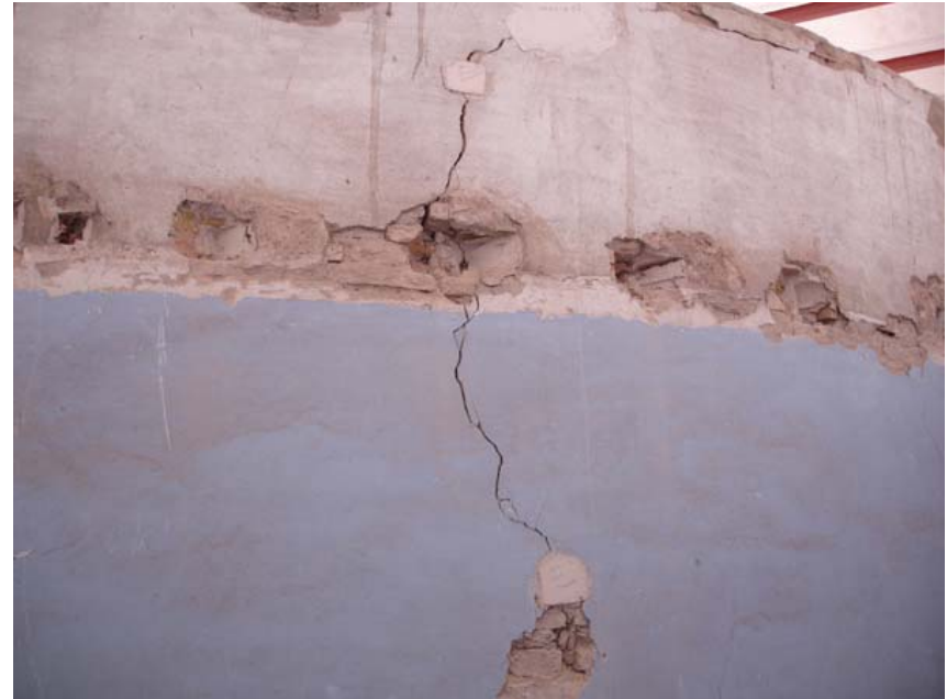
Grieta del óvalo desde la planta alta
