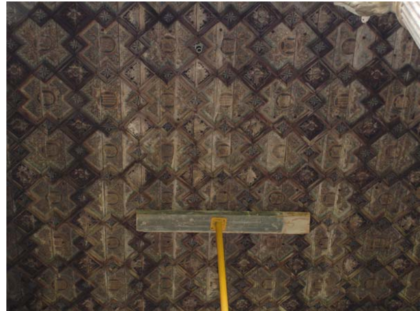
Detalle de los daños en los artesanados de las terrazas
