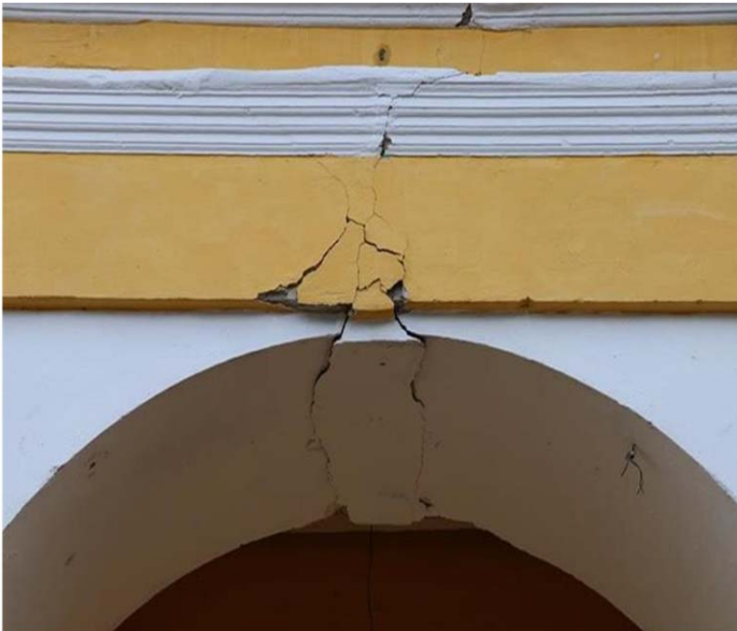
Daño arco Santa Catalina. La Antigua Guatemala
