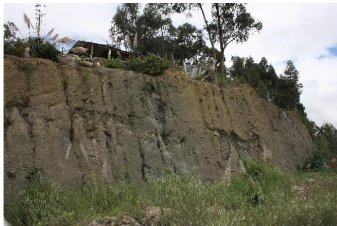
Figura 89. Afloramientos de material coluvial, donde se aprecia muy bien el proceso erosivo.
