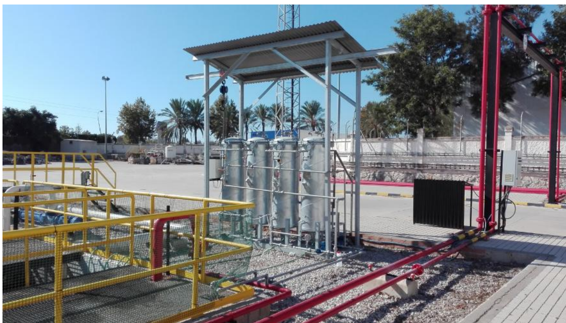
Figura 21. Vista general de la Planta Piloto en instalaciones de CLH en Motril (Granada).
