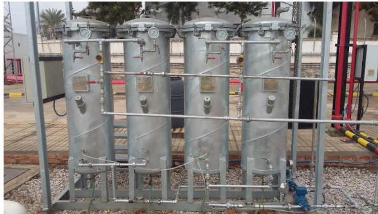
Figura 24. Vista de los 4 biorreactores instalados. Planta Piloto en instalaciones de CLH en Motril (Granada).
