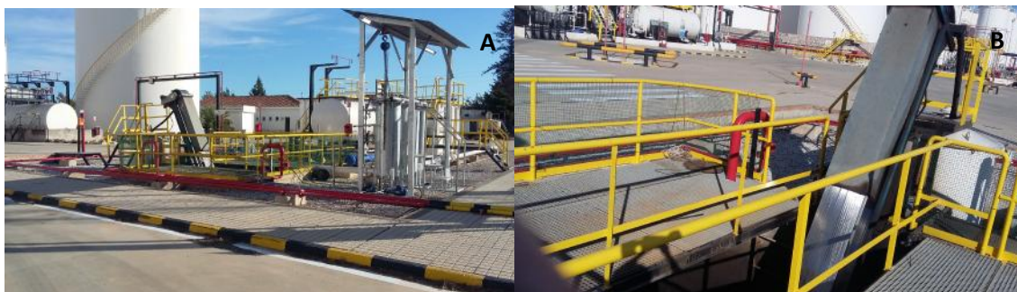
Figura 8. Vista general del depósito “API”(A). Detalle del skimmer instalado en el mismo (B).
