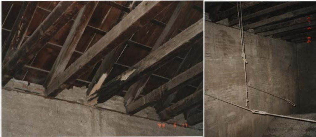
Figura 201 y 202. Pudrición de apoyo de vigas de madera. Detalle de tirante.
