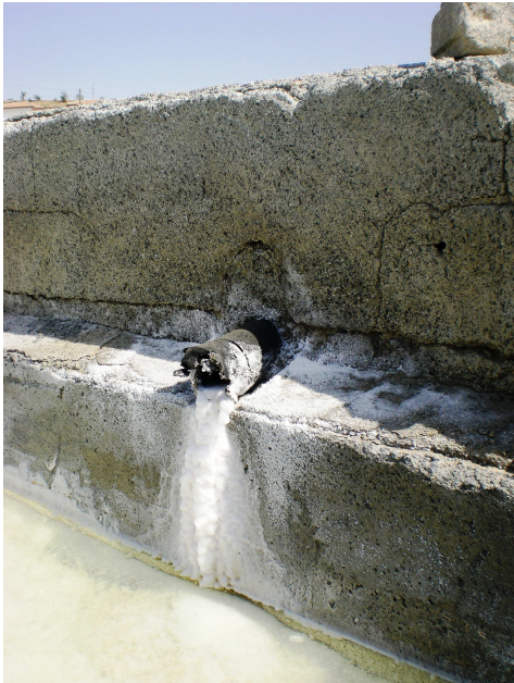
Foto. Tubería que traspasa el agua desde una alberca a otra situada a inferior cota. Obsérvese la alta concentración de sal debido a la salmuera
