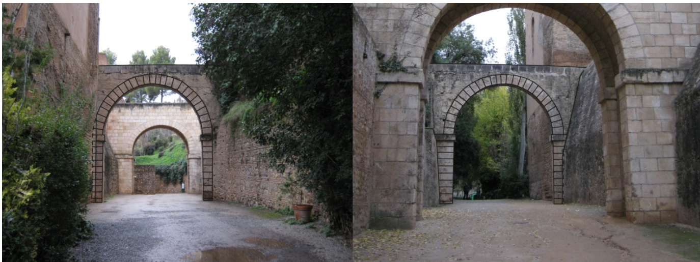
Figura 12. Ajuste fotográfico de las medidas tomadas in situ , en los alzados norte y sur de la obra.
