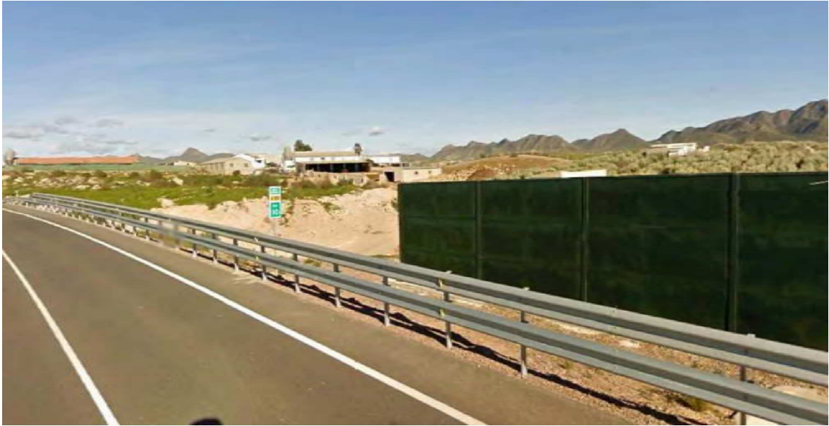
Figura 6.16: Vista de una pantalla acústica instalada en un tramo diferente de la carretera A-1201. Fuente: elaboración propia.
