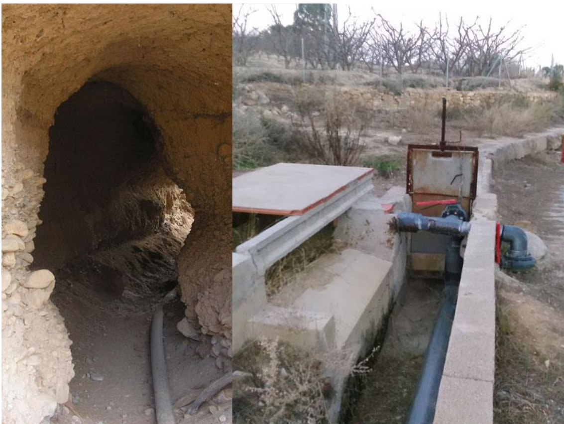
Link 03. Dos ejemplos de aprovechamiento de infraestructuras tradicionales de conducción, para instalar tuberías de distribución presurizadas, dentro del Plan de Modernización de regadíos. Una en un canal a cielo abierto y otro en un tramo minado. Fuente: Elaboración propia.
