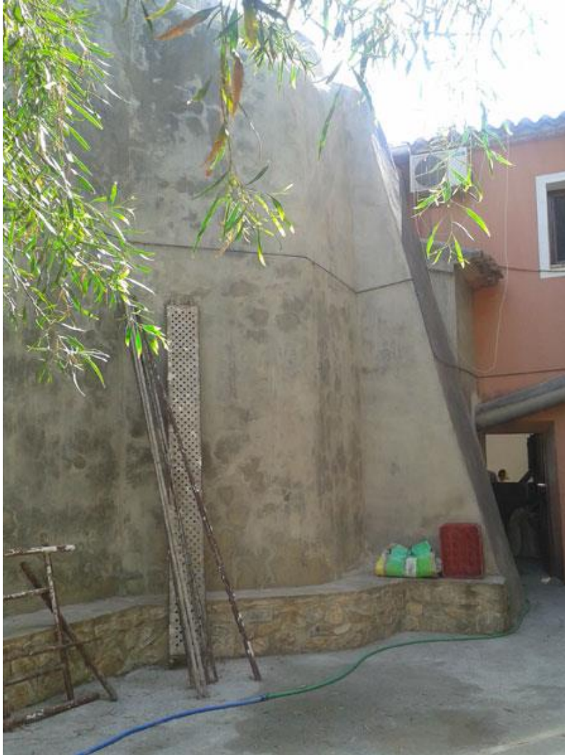
Ilustración 07. Estructura exterior del cubo del Molino de Felipe; uno de los primeros construidos en la Ribera de Los Molinos de Mula. A él aflúan las aguas desviadas de la Acequia Mayor, por un canal de 20 m de longitud. Fuente: Elaboración propia.
