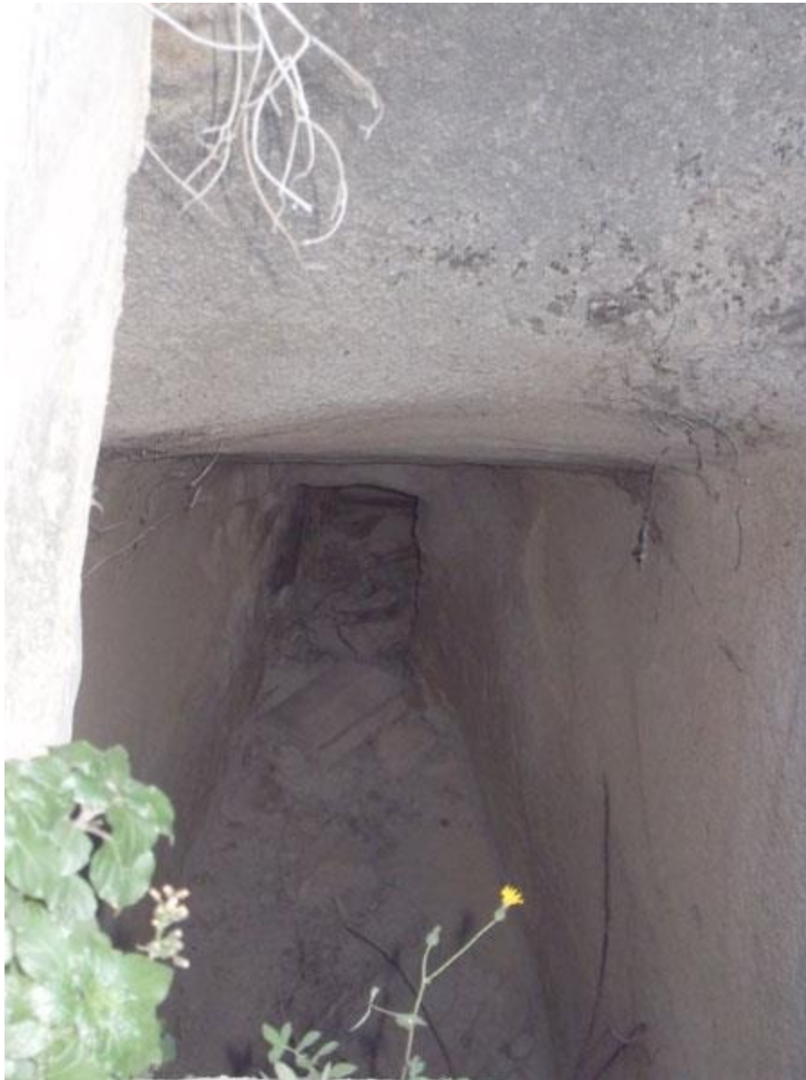
Link 04. Antigua entrada hacia el molino de José María, uno de los molinos de la Ribera de Mula. En él se puede observar el estrechamiento realizado para imprimir mayor presión al agua y por lo tanto, imprimir mayor potencia en el movimiento del molino. Fuente: Elaboración propia.
