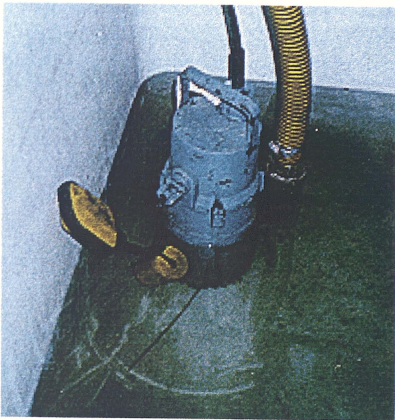
Fotografía n° 20: Bomba sumergida para agua de lavado, Caudales de 50 a 120 l/h
