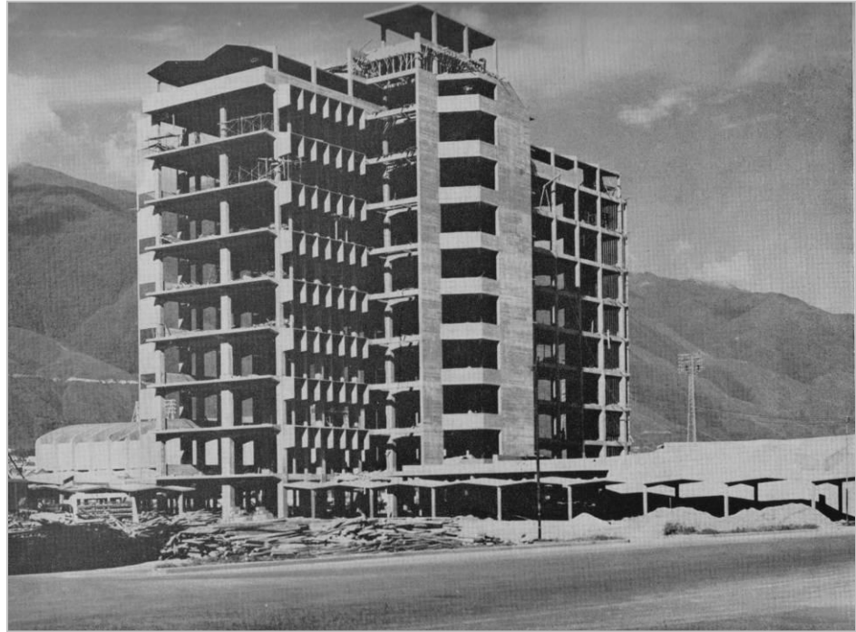
Edificio de la Facultad de Arquitectura y Urbanismo, en una de las etapas de construcción. En: República de Venezuela. Memoria y Cuenta del Ministerio de Obras Públicas, 1956. Caracas, Dirección de Cartografía Nacional M.O.P, 1956, p. 72
