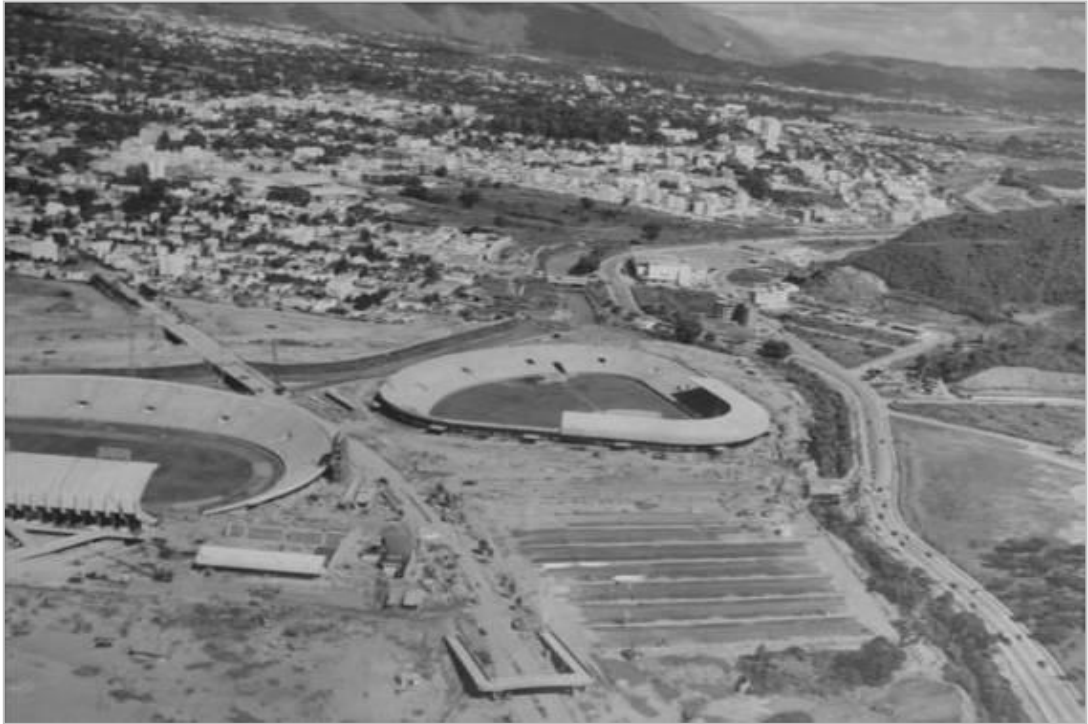
Vista de las obras del Complejo Deportivo de la Ciudad Universitaria de Caracas, 1951. En: Archivo del Instituto Ciudad Universitaria – En custodia Consejo de Preservación y Desarrollo – COPRED – UCV.
