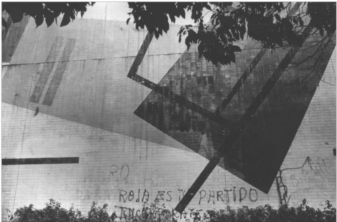
Aspecto del deterioro que presentaba el Mural creado en 1953, por el artista Mateo Manaure, donde se valora la técnica ejecutada con cerámica tipo Clay Craft 75 x 150 m/m, cuya composición fue realizada en toda la superficie dividiéndose cada una de las formas abstractas en varios sectores, que se distinguen claramente en la fotografía. En: Colección Ciudad Universitaria de Caracas – Instituto Ciudad Universitaria – ICU, Consejo de Preservación y Desarrollo, Universidad Central de Venezuela.
