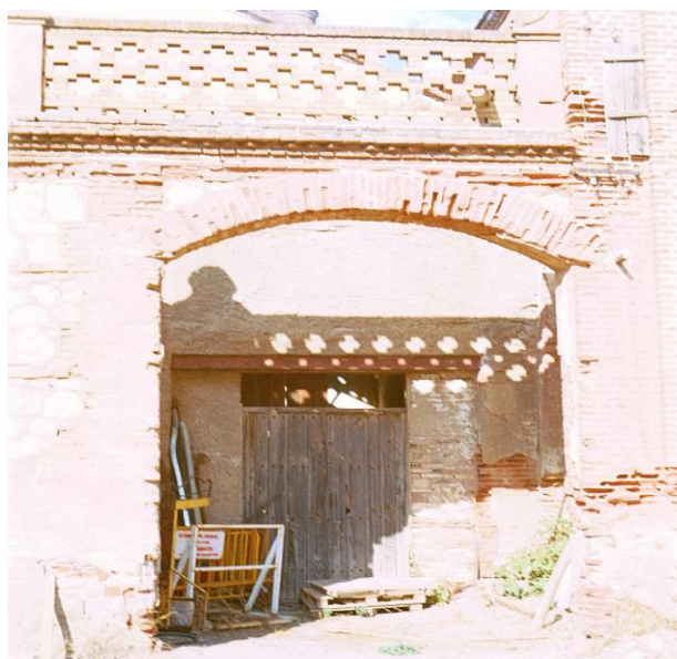
Fig. 117. Fotografía del acceso a los almacenes de la azucarera San Torcuato (Guadix)
