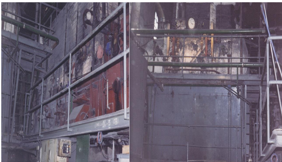
Figs. 499 y 500. Dos fotos de calderas de vapor que utilizaban bagazo para quemar (izquierda) o carbón (derecha) de la azucarera de Guadalfeo (Salobreña)
