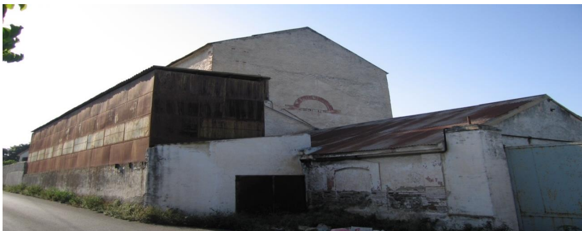
Fig. 487. Foto del estado actual de las construcciones de la azucarera San Luís (Motril)
