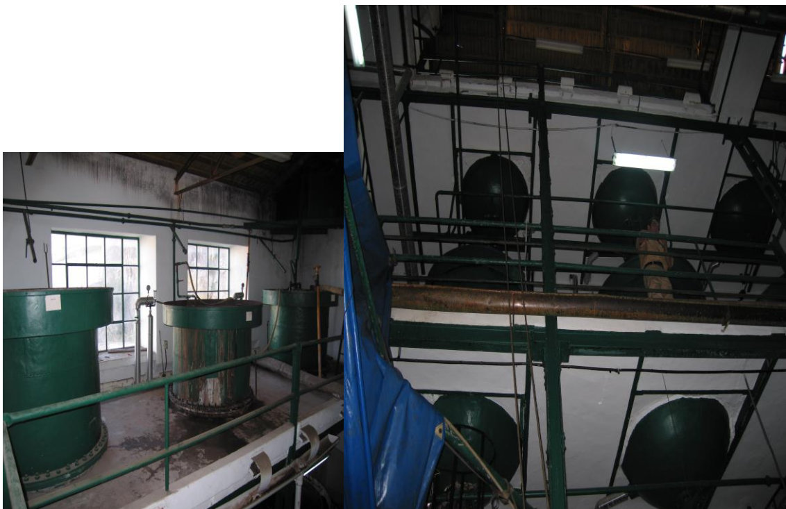
Fig. 206. Aparatos y maquinaria instalada en dos pisos o niveles en una de las dependencias del Ingenio
