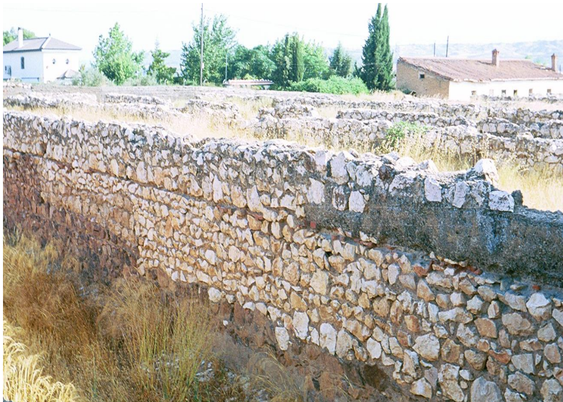
Fig. 592. Foto del estado actual de los silos de remolacha de la azucarera San Torcuato
