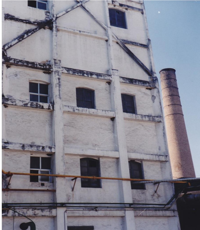
Fig. 511. Foto de la alcoholera y la primera chimenea de la azucarera de Guadalfeo
