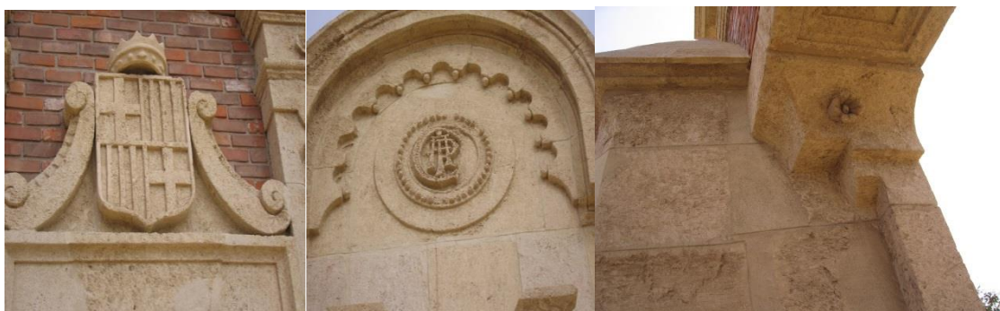
Fig. 611. Tres fotos de los detalles de la puerta de acceso al recinto de la azucarera Ntra. Sra. de Montserrat
