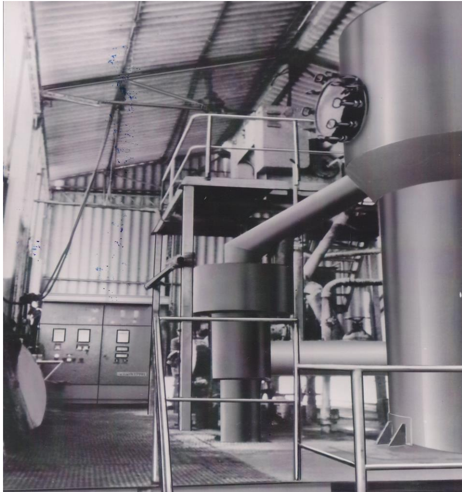
Fig. 4. Carbonatación continua en la azucarera de Torre del Mar. Fuente: ASAL
