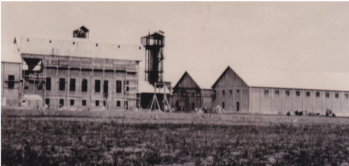
Fig. 92 y 93. Dos fotografías de dos momentos en la construcción del Cuerpo de fábrica de la azucarera Hispania (Malaga). Fuente: ASGAE. Benavente
