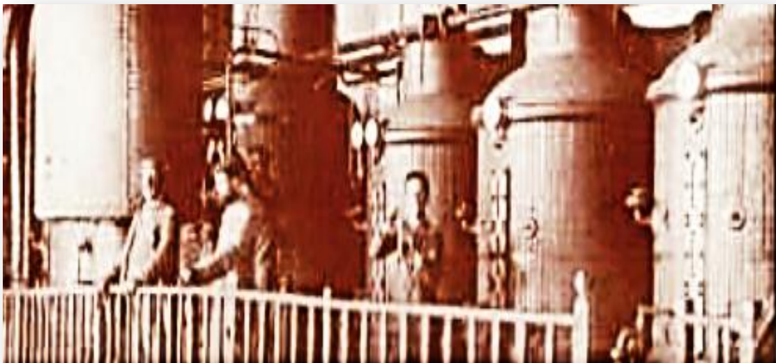
Fig. 607. Fotografía de la sección de evaporación de la azucarera de San Nicolás (Adra). Fuente: Adra Cultural
