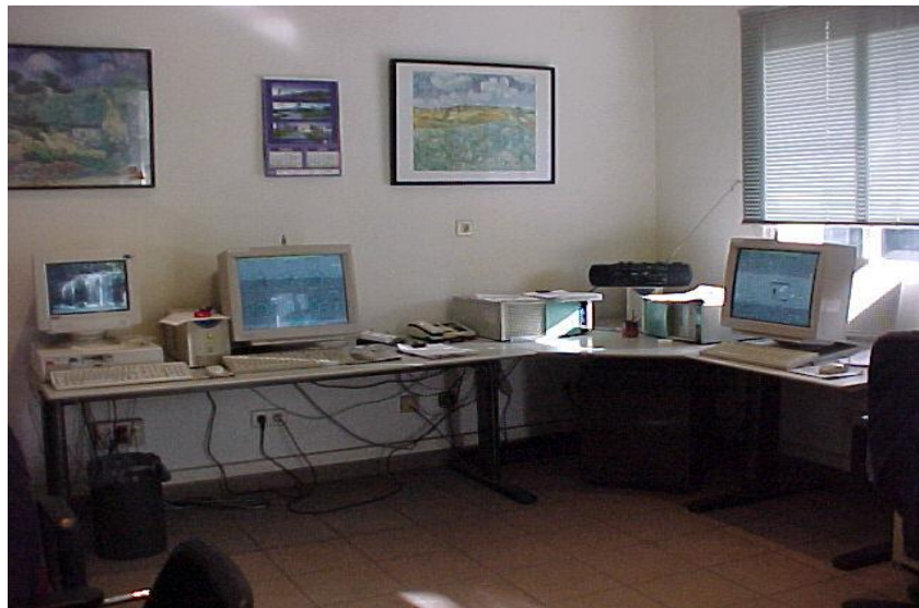
Fig. 532. Fotografía de la sala de control (derecha). Fuente: ASGAE
