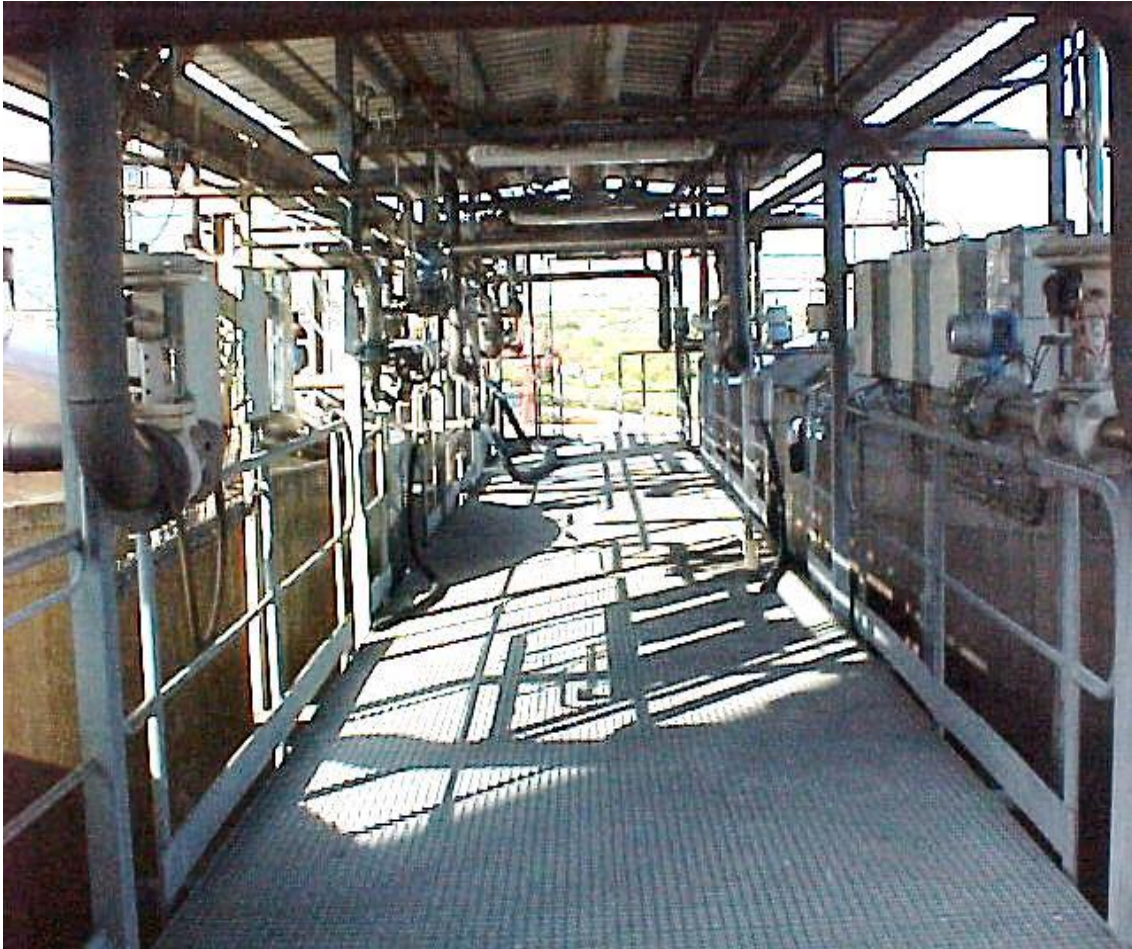
Fig. 543. Foto de la fermentación nueva en la destilería San Francisco. Fuente: ASGAE
