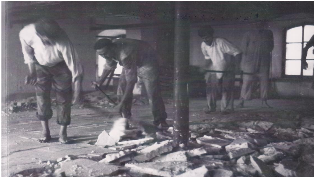
Fig. 236. Foto del almacén de azúcar pilé de los años sesenta. Se incendió. Fuente: ASAL
