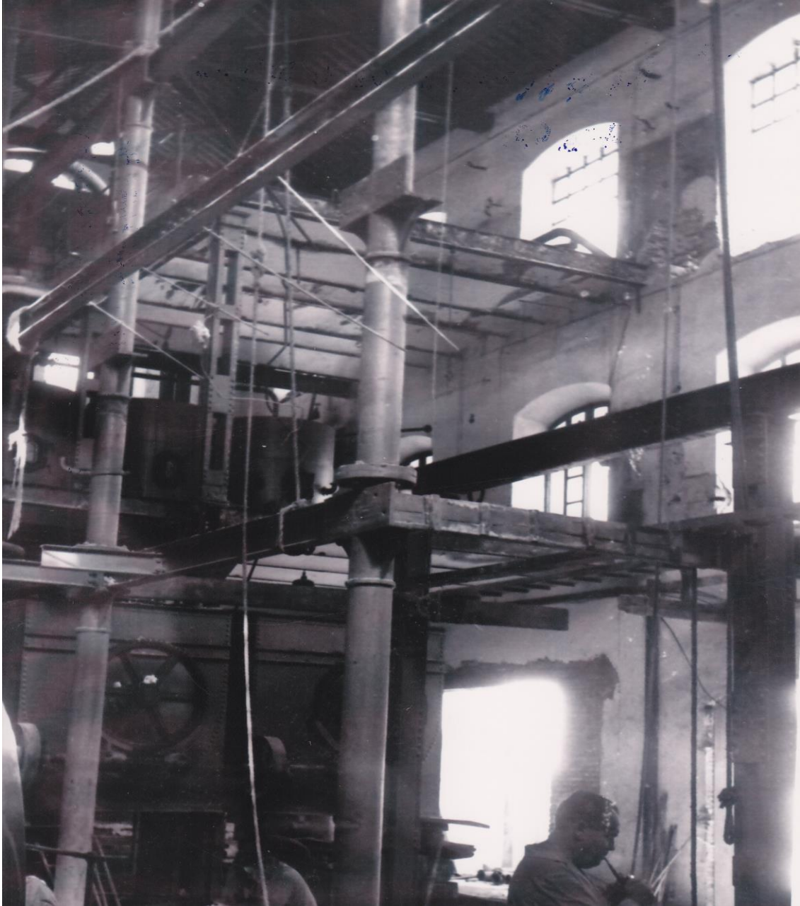
Fig. 71. Fotografía de las columnas de hierro fundido de la sección de evaporación y cocción de la azucarera de Torre del Mar (Málaga). Fuente: ASAL
