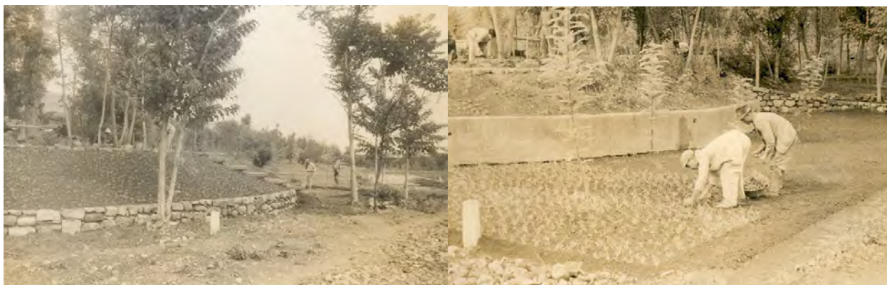
Figura 2.74: Fotografías de las obras de jardinería en los primeros años de ejecución del
