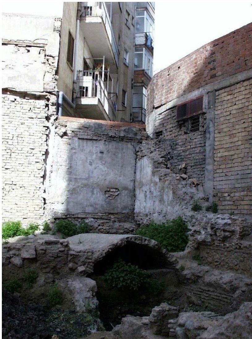
Fig. 167. Solar de Calle San Francisco. Detalle de la bóveda de ladrillos que cubría el foso o Val de San Antolín. El recorrido de esta infraestructura generó en este tramo una servidumbre entre fincas
