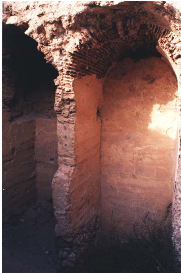
Fig. 97. Monteagudo (Murcia). Castillo. Tercer cuarto del s. XII. Obsérvense los alzados de tapial de hormigón y las bóvedas de ladrillo sobre las que se extiende un relleno de argamasa que permitió crear una superficie aterrazada
