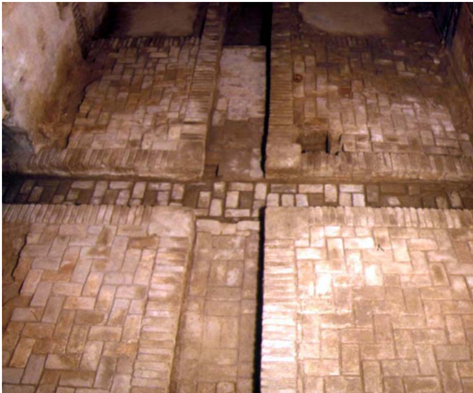
Fig. 96. Murcia. Dâr al-Sugrà . Palacio mardanisí hallado en el subsuelo del convento de Santa Clara la Real de Murcia. Pavimento del pabellón central del jardín de crucero. Probablemente, la solería de ladrillo es una reforma de época almohade
