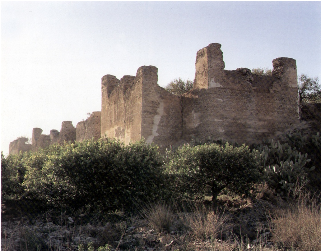
Fig. 95. Monteagudo (Murcia) Castillejo. Vista de la esquina (entrante) noreste del palacio. Tercer cuarto del s. XII
