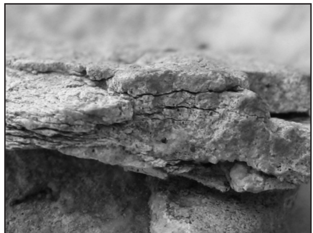
Figura 9. Desplacado de la cornisa que separa la planta alta de la baja. Es visible en su interior la presencia de una fuerte fisuración que delimita múltiples escamas. Figure 9. Spalling of the cornice that separates the high floor of the ground floor. It is visible in its inside the presence of one strong fissure that delimits multiple flaks.
