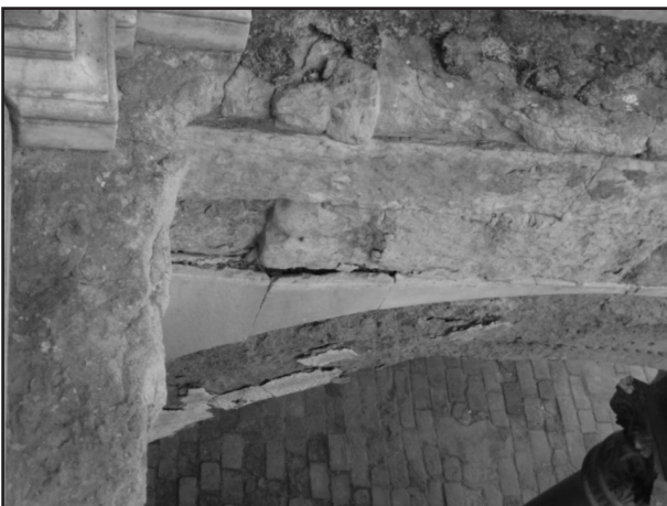
Figura 8. Las placas de mármol corren peligro de caída, al estar en muy mal estado la piedra caliza que la soporta. Figure 8. The marble slabs are in danger of falling, when is in very poor condition the limestone that it supports.
