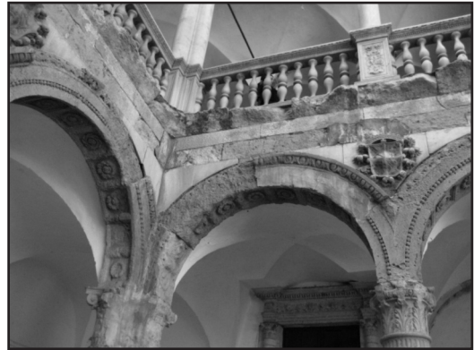
Figura 7. Deterioros en una de las esquinas de la planta baja del patio. La piedra caliza local es la más afectada por la agresión del agua de lluvia y el viento.
