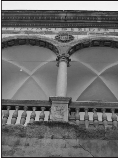
Figura 6. Detalle del estado de conservación de una de las fachadas del patio. Los mayores deterioros se concentran bajo la trayectoria de caída del agua desde el tubo de evacuación. La pérdida de material pétreo afecta principalmente a la piedra caliza local.
