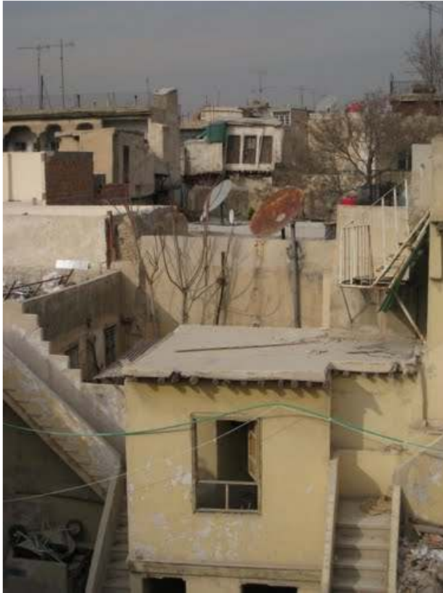
Fig.5. 16. Damasco. Estado ruinoso de las casas
