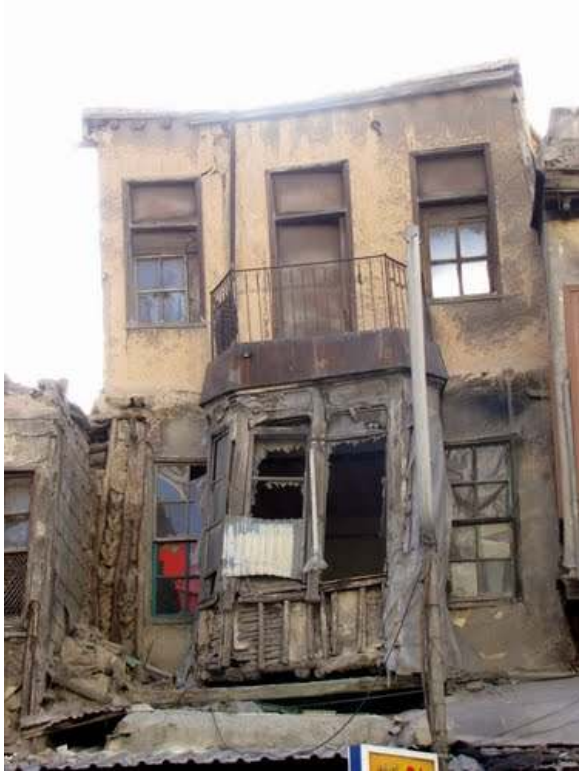
Fig.5. 18. Damasco. Estado ruinoso de las casas (Fakoush.B)
