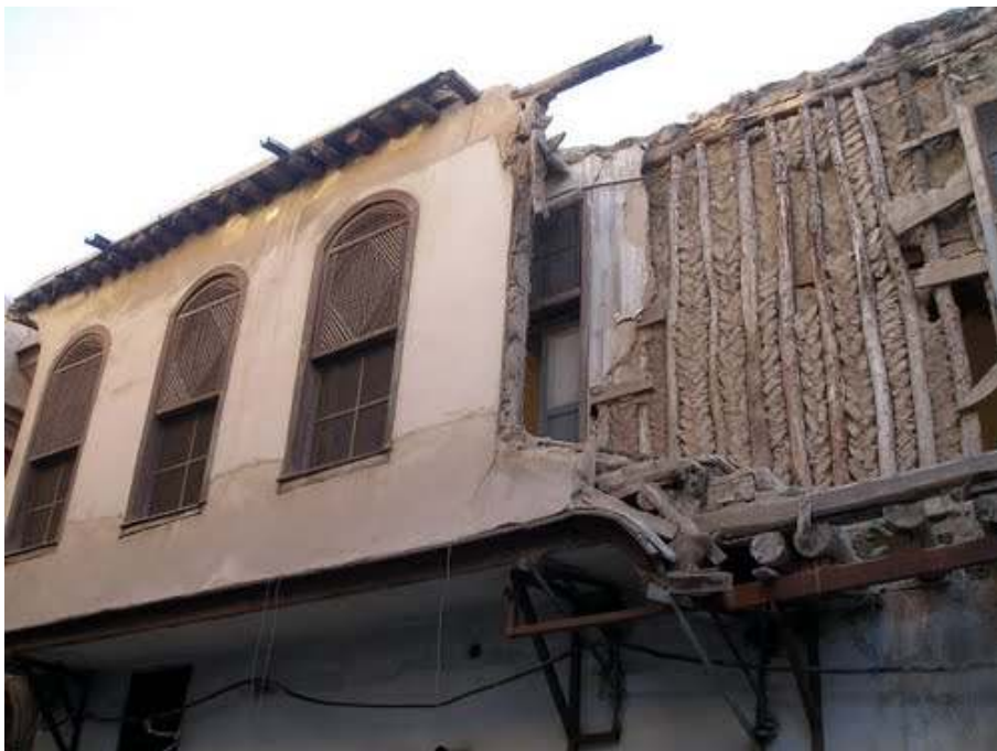
Fig.5. 17. Damasco. Estado ruinoso de las casas
