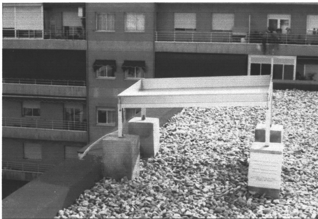
Figura 11. Batea colectora del agua de lluvia
