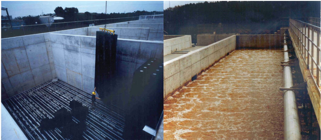
Figura I.7. Instalación y funcionamiento de una planta de filtros sumergidos aireados (SFBBR).
