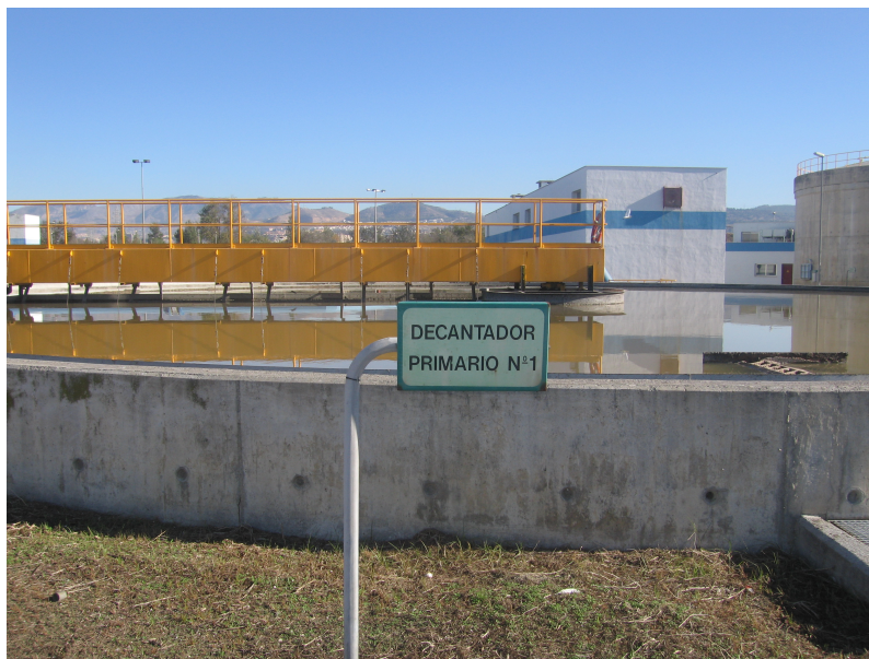
Figura II.5. Vista general del decantador primario de la estación depuradora del Sur (EMASAGRA).
