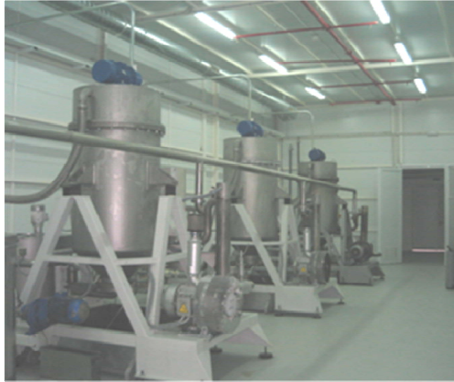
Figura 18. Sala de filtración (Aceites Maeva S.L.).
