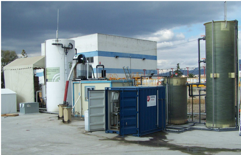
Figura 3.1. Vista general de las dos instalaciones experimentales.
