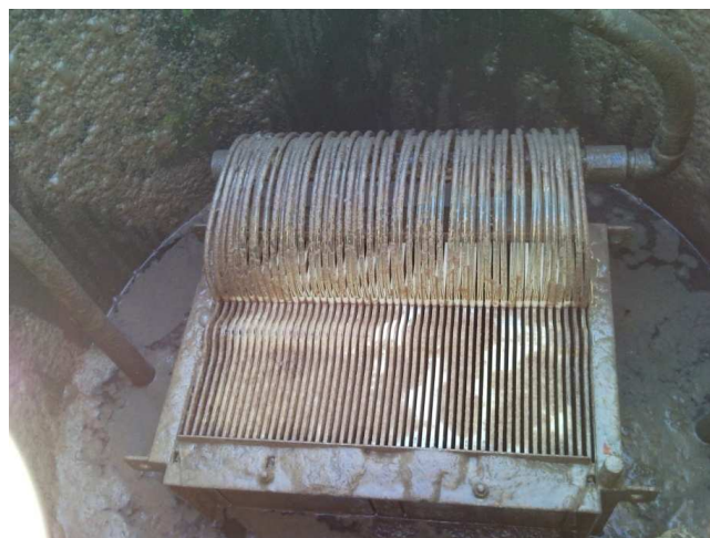
Figura 3.11. Módulo de membranas de microfiltración instalado.
