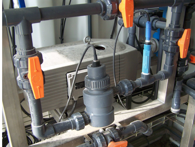
Figura 3.10. Circuito de fango de la instalación de microfiltración con la ubicación de los electrodos.
