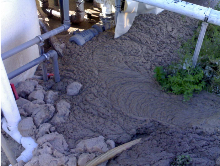
Figura 4.87. Derrame de fango por flotación en la planta de ultrafiltración.
