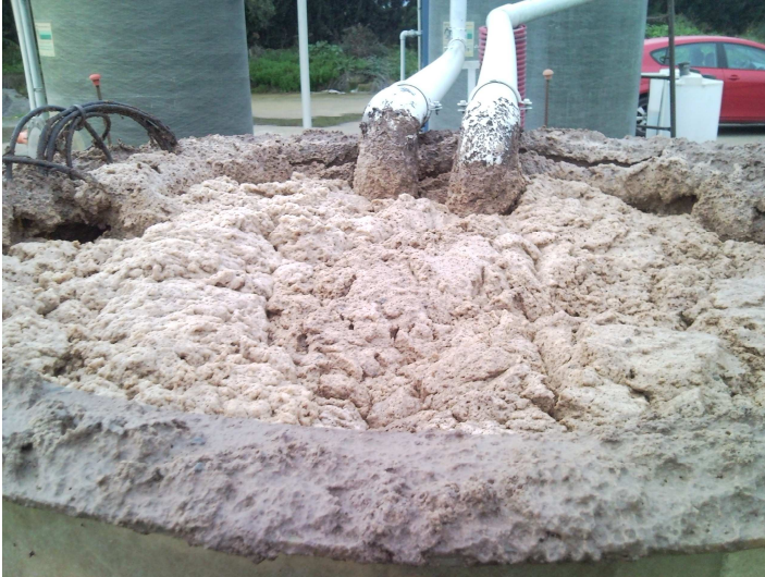
Figura 4.88. Espumas en reactor anóxico en planta de microfiltración.
