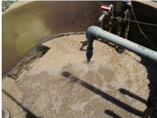
Figura 3.9. Sistema de aspersión de fango en tanque aireado de la instalación de microfiltración.
