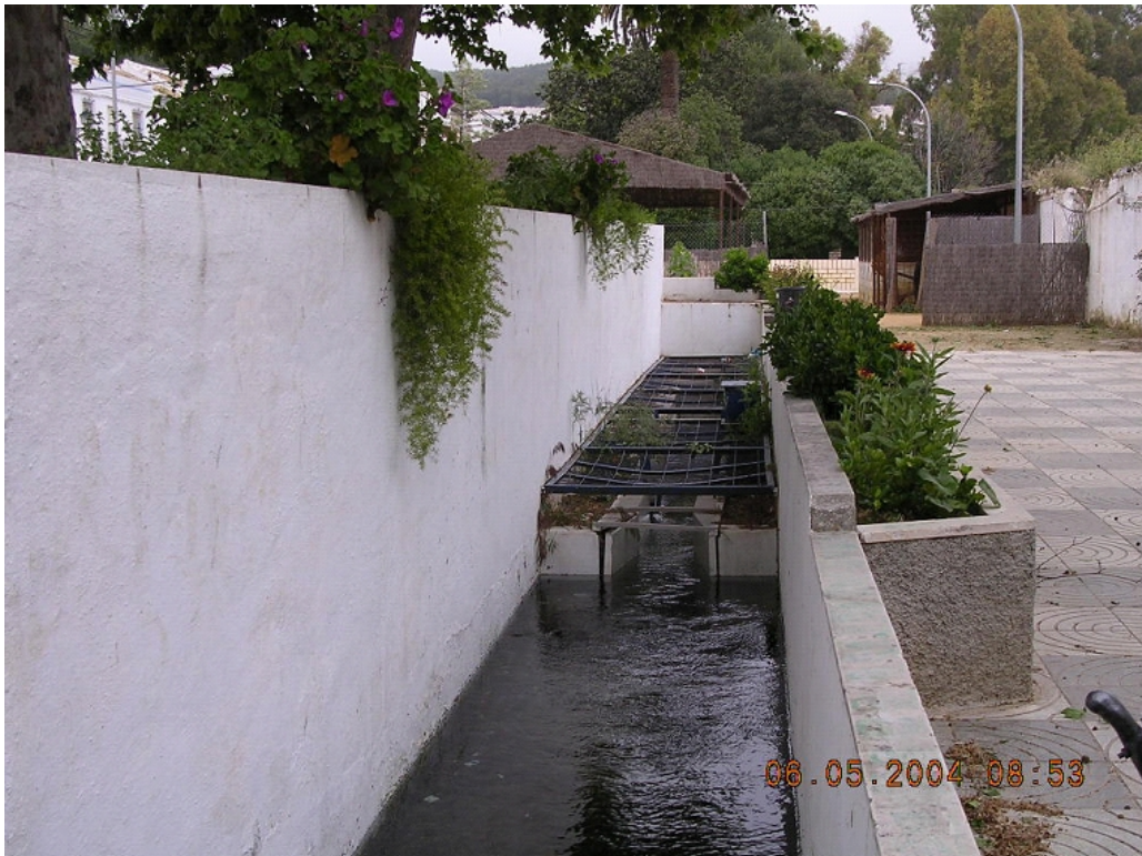
Fotografía 4.1. Detalle de la estación de aforo (vertedero rectangular y limnígrafo con recolector de datos digital) instalado en la acequia que recoge la descarga del Ojo de Gilena.
