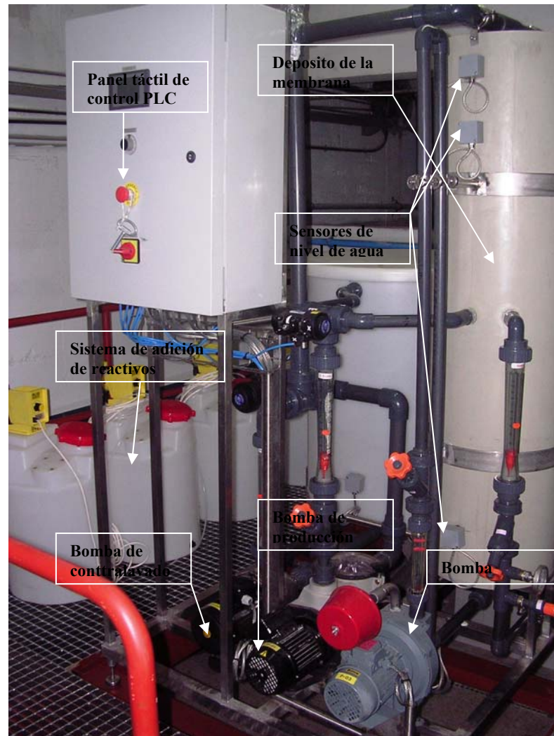
Figura 12. Planta piloto de ultrafiltración con tecnología Trisep.
