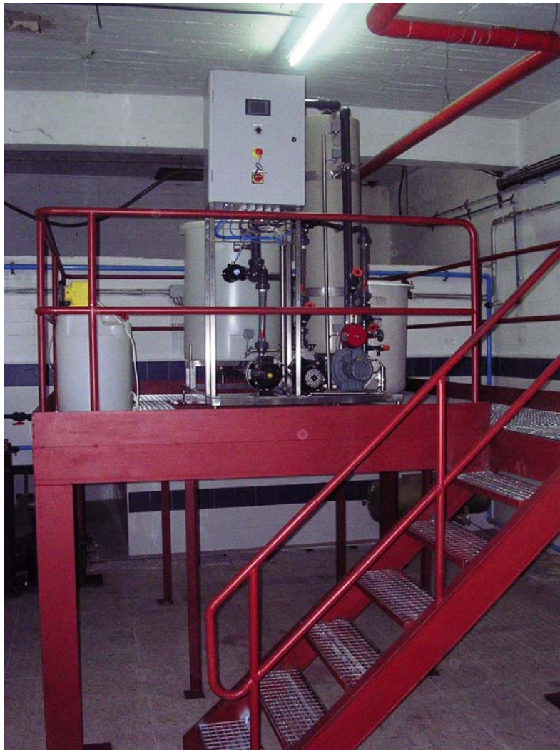
Figura 7. Aspecto de la instalación experimental.
