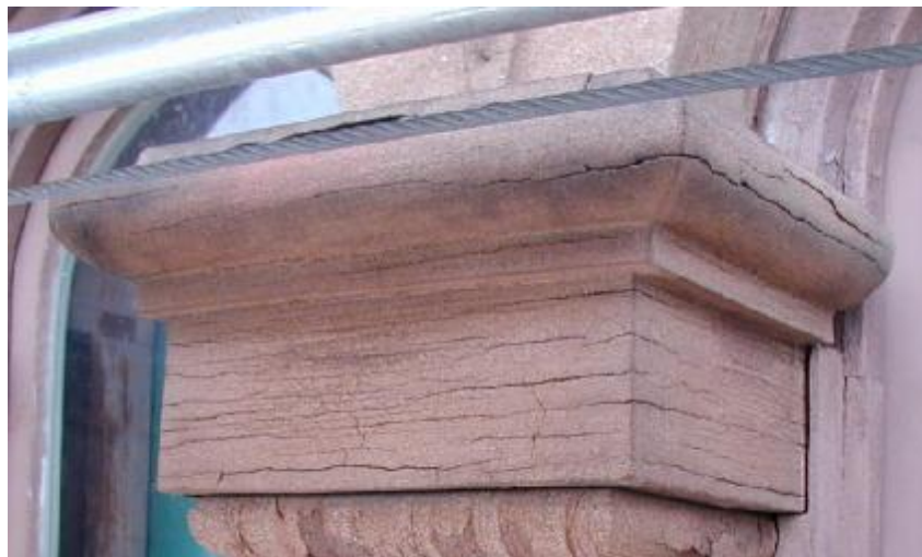
Figura 3-23. Ilustración de un caso probable de degradación durante el secado en la arenisca Portland Brownstone. En consonancia con lo indicado en la Tabla 3-3, las grietas se producen siguiendo los planos de sedimentación del material, lo que corresponde a esfuerzos dañinos en la dirección perpendicular a dichos planos. Este capitel, perteneciente a la fachada de la “Victoria Mansion” (en Portland, Maine, EE.UU.), parece mostrar esta forma de degradación (foto proporcionada por I. Myjer).
