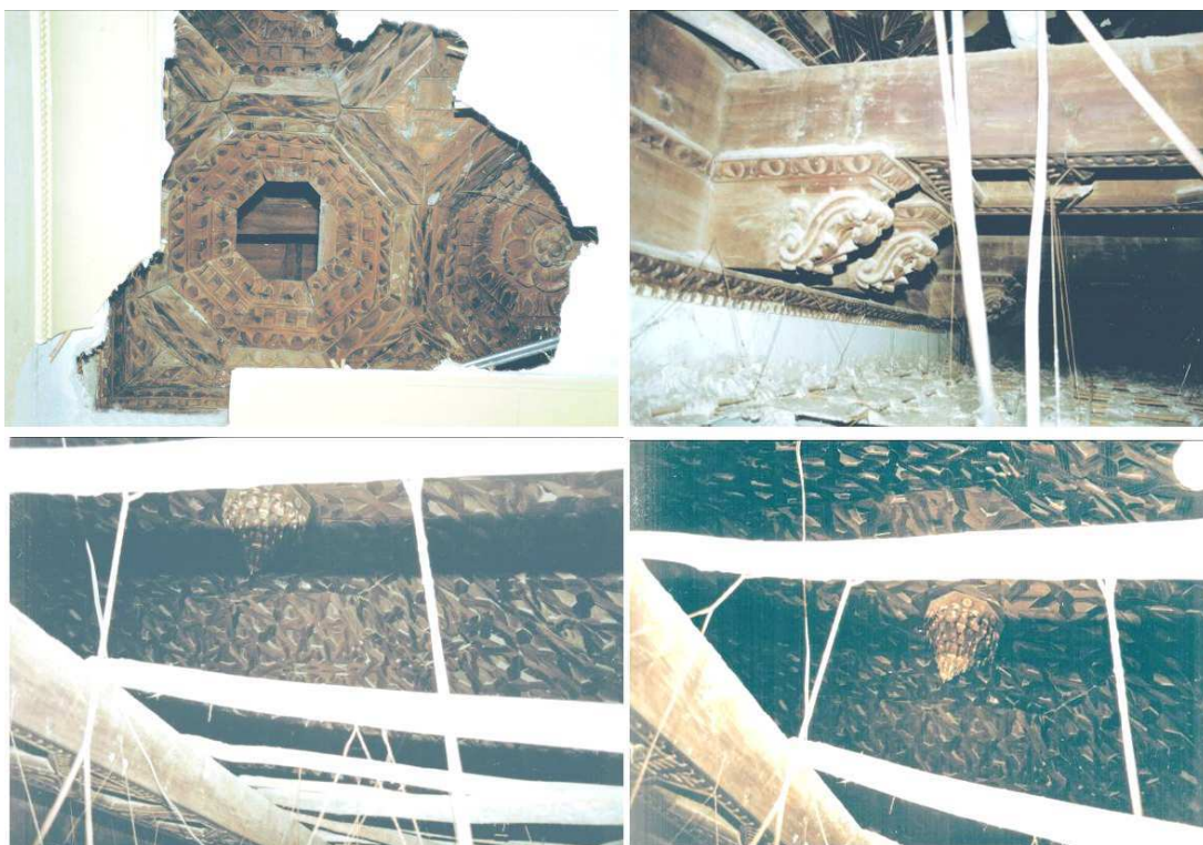
Fig.11: primeras imágenes de la armadura de la nave, tras la apertura del cielo raso de escayola. Fotografías: Esteban Fernández Navarro, 1998.
