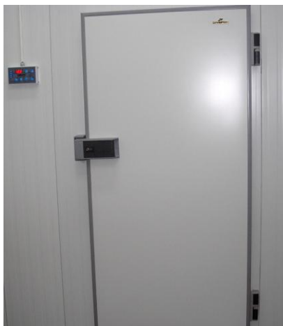
Figura 6. Cámara frigorífica para obras delicadas. Perteneciente al Museo de Bellas Artes de Granada
