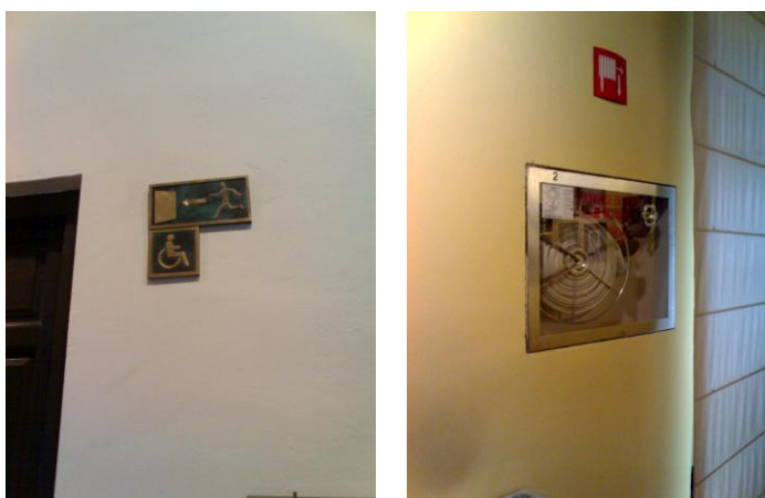
Figura 16. Algunos sistemas de seguridad de un museo -señalizaciones y manguera de extinción de incendios-
