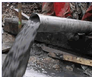
Figura 3.1. Vertido de lixiviados.
