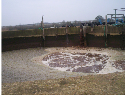
Figura 4.5. Tratamiento de lixiviado mediante fangos activos.
