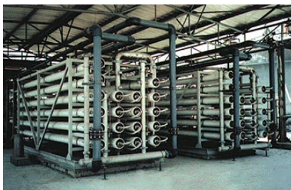
Figura 4.4. Planta de ósmosis inversa.
