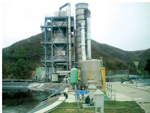
Figura 4.3. Torre de stripping para tratamiento de lixiviado.
