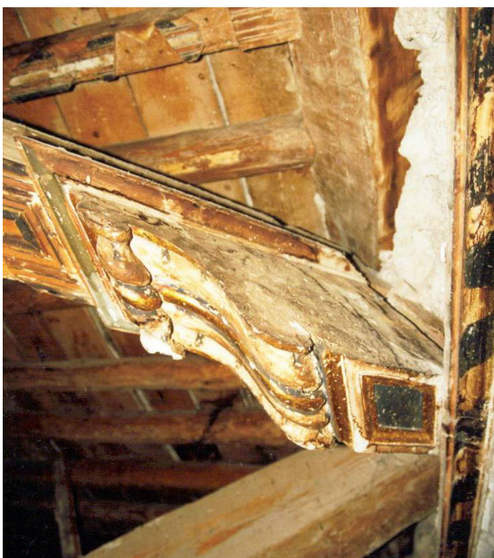
Iglesia de San Juan. Restos de la armadura primitiva.
