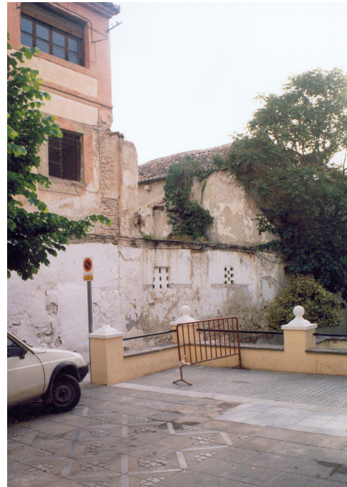
Alhóndiga. Fachada lateral hundida.
