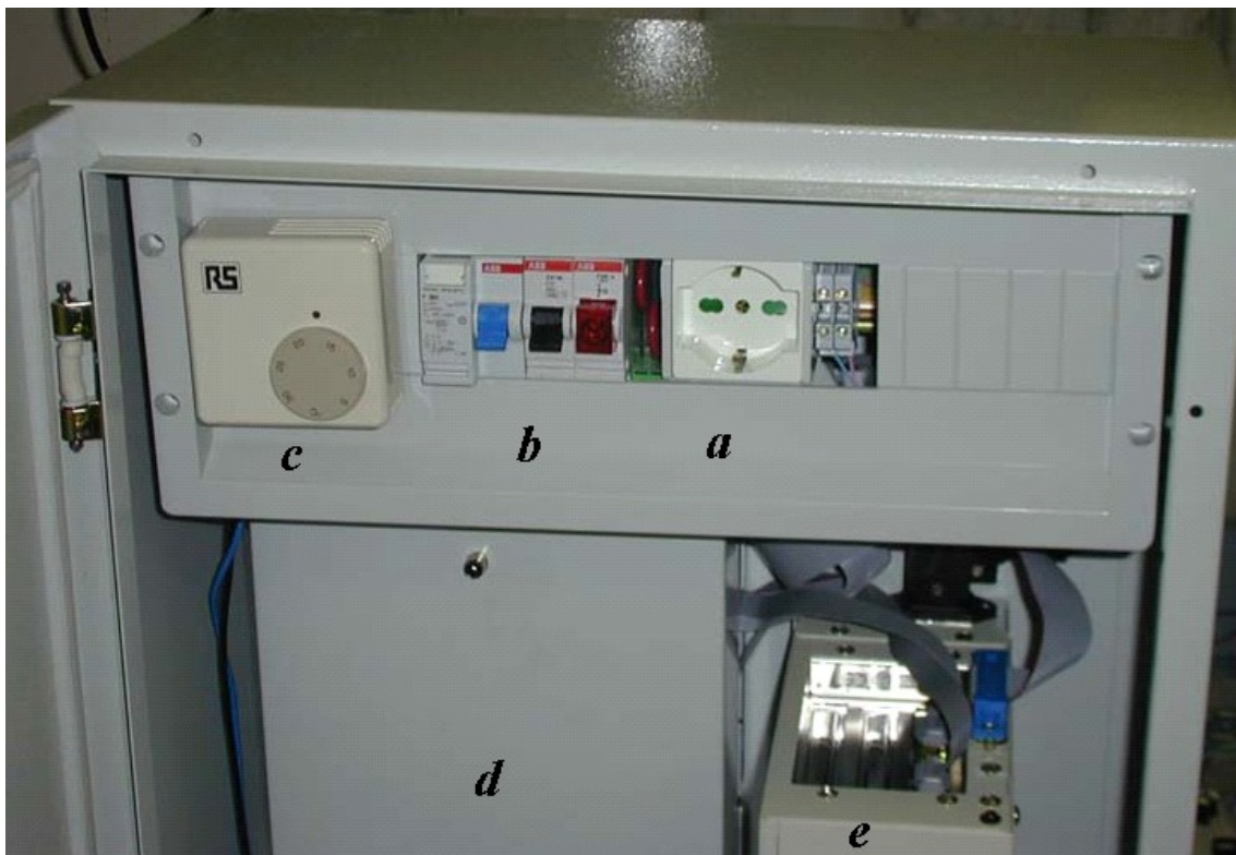
Figura 3.36. Aspecto interno de uno de los contenedores de las estaciones, en el que pueden apreciarse la base de red con toma de tierra (a), los interruptores diferenciales de protección (b) y un termostato (c) para mantener constante la temperatura interna. En el contenedor (d) está alojada la electrónica de adquisición y en (e) la fuente de alimentación y el PC industrial, iguales a los del PC nodal mostrados en la figura 3.35.
