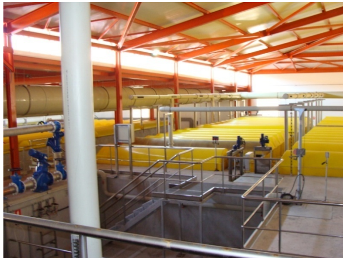
Figura 61- Vista de la sala de decantación y reactor.
