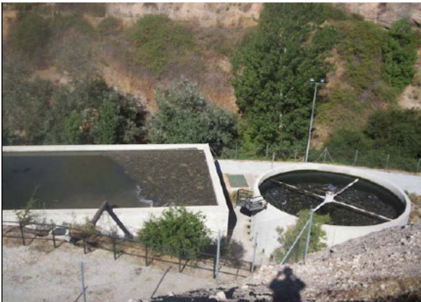
Figura 48. Vista general de la depuradora de Huétor Santillán
