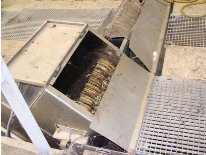
Figura 15. Vista de rejas de finos del pretratamiento de la planta de depuración de Motril.
