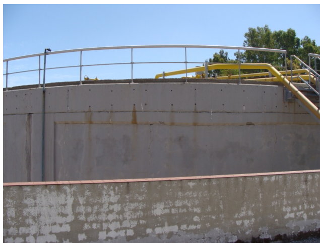
Figura 40. Digestor anaerobio de Sanlúcar de Barrameda.
