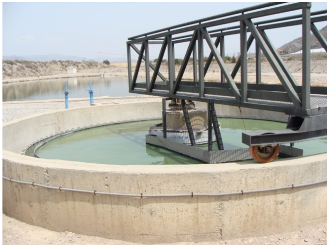
Figura 30. Decantador secundario de la depuradora de Palomares.
