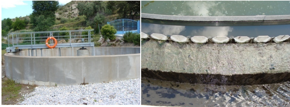
Figura 24. Decantador secundario de la instalación.
