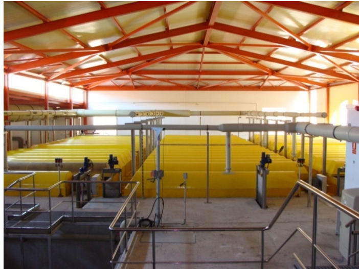
Figura 62. Vista del reactor biológico.
