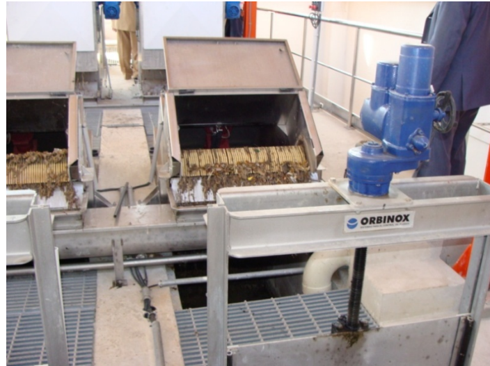
Figura 59. Vista de rejas de finos del pretratamiento.
