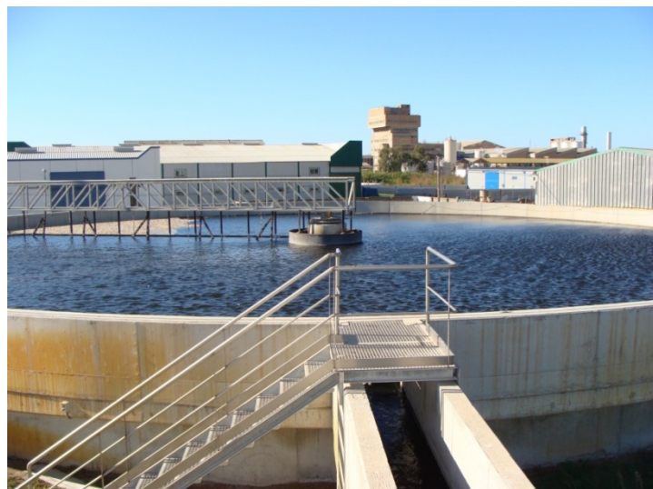
Figura 19. Decantación secundaria de la depuradora de Motril.
