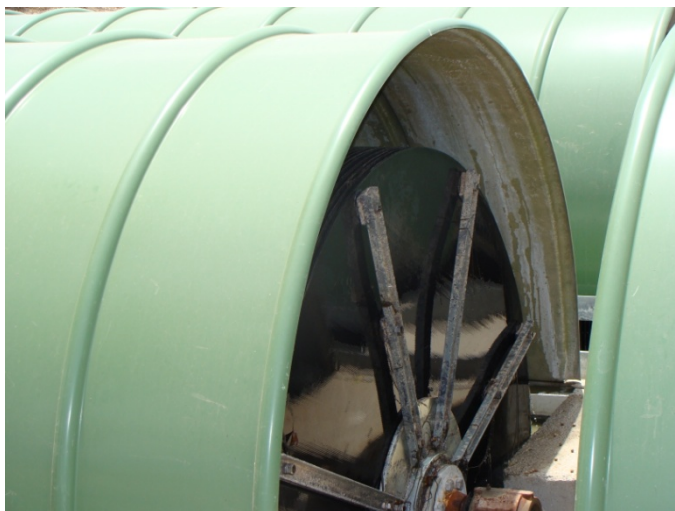
Figura 56. Biodiscos del reactor biológico de la planta de Cuevas.
