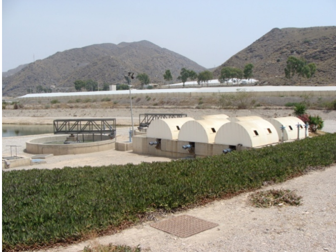
Figura 31. Vista de los biodiscos y de los decantadores secundarios de la planta de Palomares.
