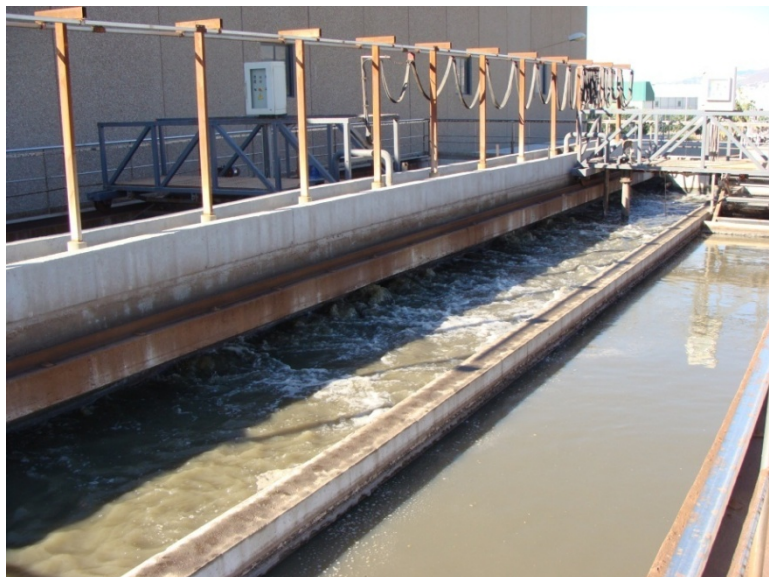
Figura 16. Vista del desarenador-desengrasador
