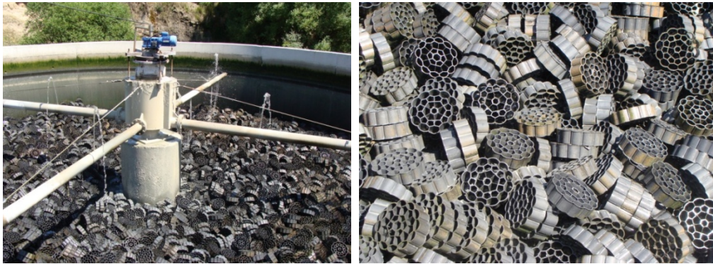
Figura 51. Relleno plástico del lecho de la planta de Huétor Santillán.
