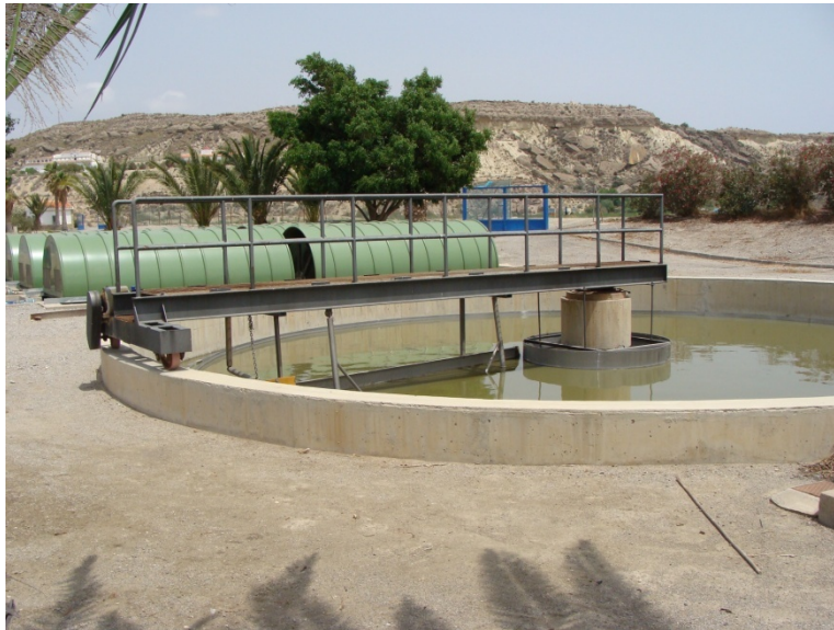
Figura 57. Decantador secundario de la depuradora de Cuevas.
