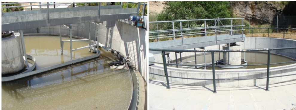
Figura 52. Decantador secundario de la planta de Huétor Santillán.
