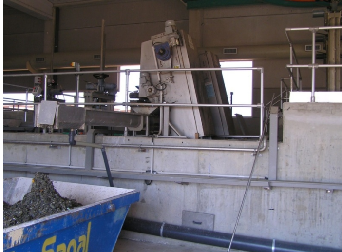
Figura 44. Vista de rejas de finos del pretratamiento.
