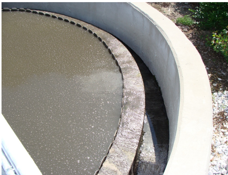
Figura 25. Vista del espesador-digestor de la instalación.
