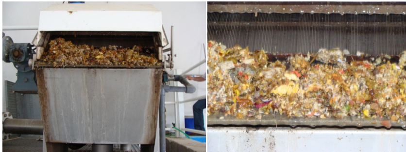
Figura 21. Tamiz rotativo del pretratamiento de la instalación.
