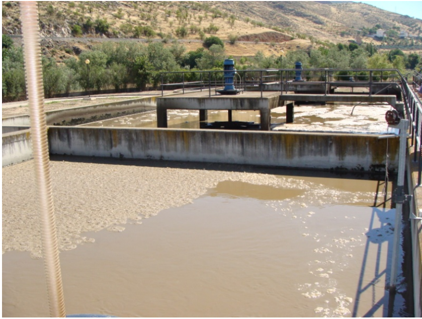
Figura 42. Vista de reactor de fangos activos de baja carga de la planta de Loja.
