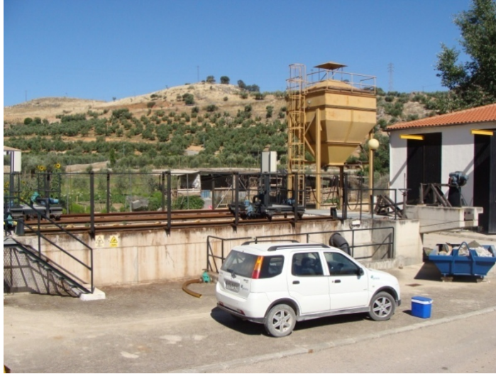
Figura 41. Vista general del pre-tratamiento.
