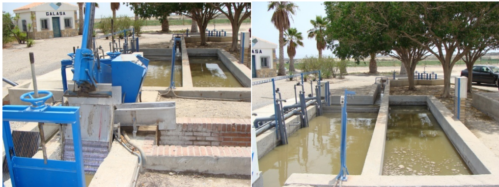
Figura 54. Tamiz de agua de llegada y desarenador-desengrasador de la planta de Cuevas.
