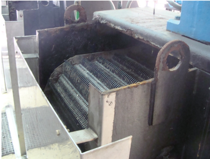
Figura 37. Vista de rejas de finos del pretratamiento de la planta de depuración de Sanlúcar de Barrameda.
