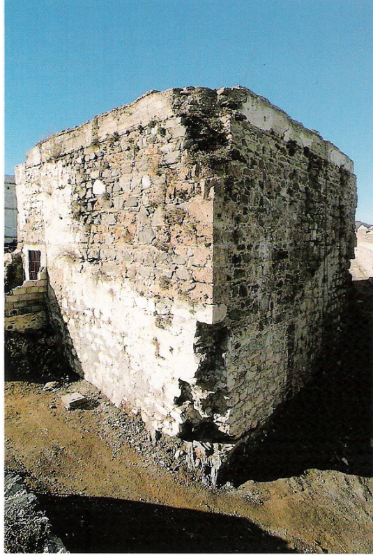
Figura 13. Torre del Homenaje de la Alcazaba de Almuñecar (Granada). Tomado de MALPICA CUELLO, Antonio: Poblamiento y castillos en Granada , Barcelona, 1996.
