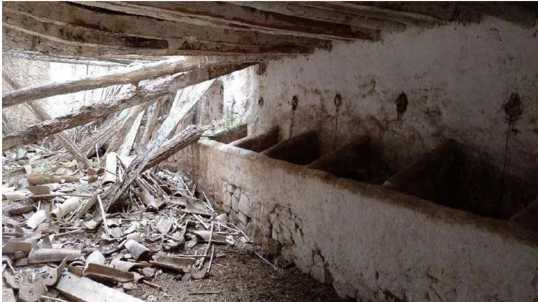
Figura 58. Cuadra del Encebro con parte del techo hundido. Fuente: elaboración propia, 2020
