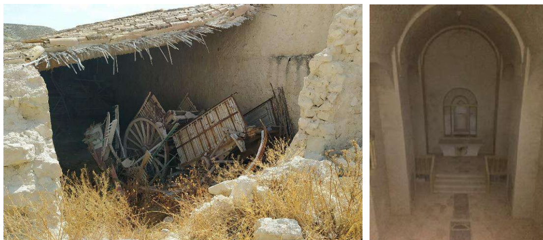
Figura 92. Figura 92A. Carretas expuestas a la intemperie por el derrumbe. Fuente: elaboración propia, 2020. Figura 92B. La capilla excavada del cortijo. Fuente: elaboración propia, 2016
