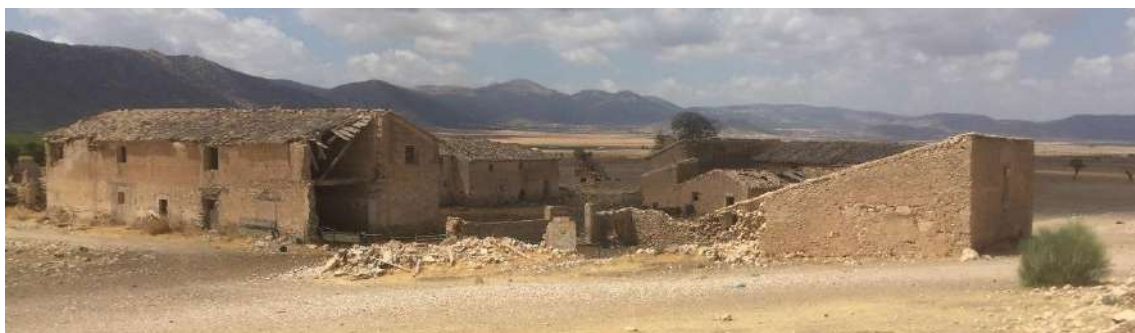
Figura 91. Principios de derrumbe en Casablanca. Fuente: elaboración propia, 2019
