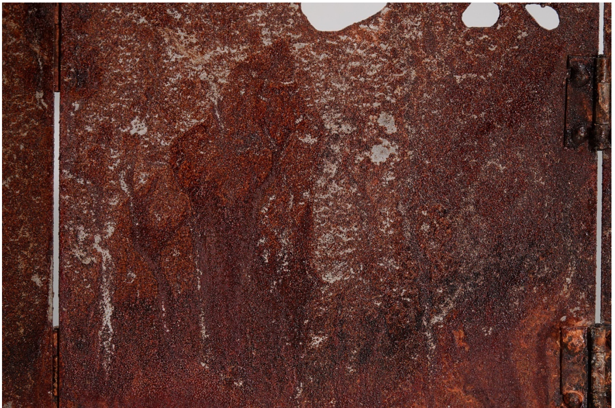
Figuras 42 y 43. Alturas, texturas y óxido.
